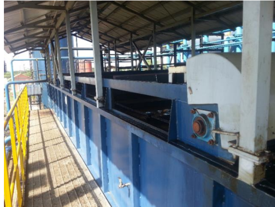
Figura 9. Sistema de tratamiento de flotación: DAF, fotografía.
