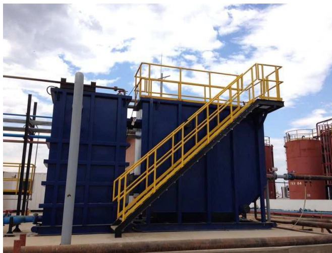
Figura 8. Interceptor de placas corrugadas (CPI)
