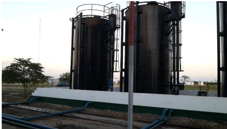
Figura 7. Skimming Tank: Fotografía.
