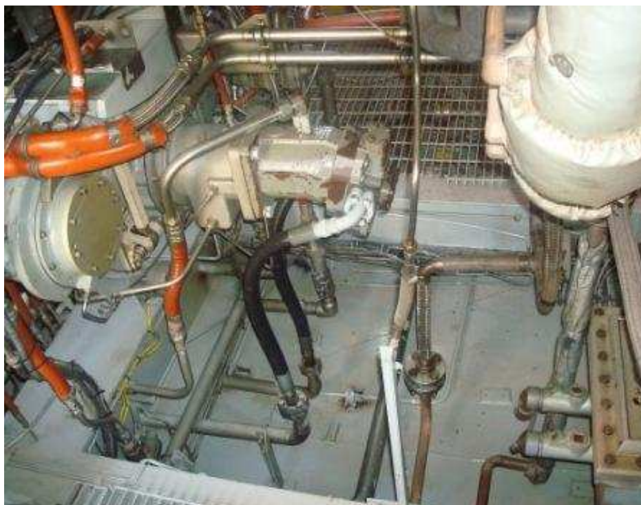
Figura 49. Vista del piso del enclosure debajo del arrancador hidráulico
