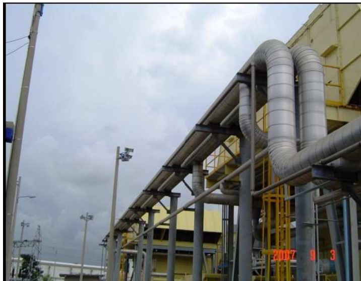
Figura 40. Tubería de entrada del agua refrigerada
