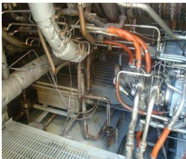
Figura 50. Vista del estado de la bomba de lubricación, mangueras y demás accesorios.
