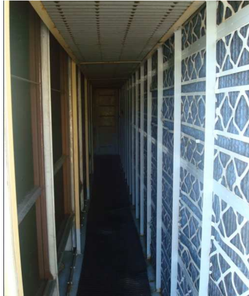
Figura 42. Área de filtros donde se realiza el enfriamiento del aire
