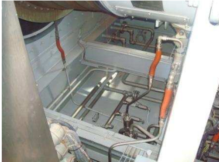
Figura 47. Vista de la parte inferior de la turbina 4 horas después de apagada la unidad.
