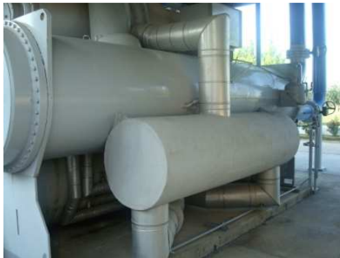
Figura 38. Conformación del chiller
