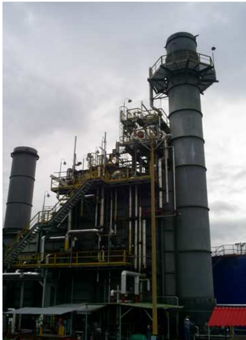
Figura 18. Fotografía de la unidad recuperadora HRSG
