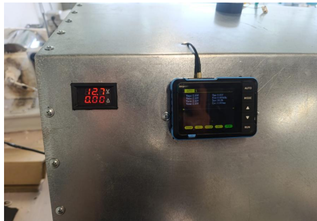
Figura 54. Tableros de medida.
