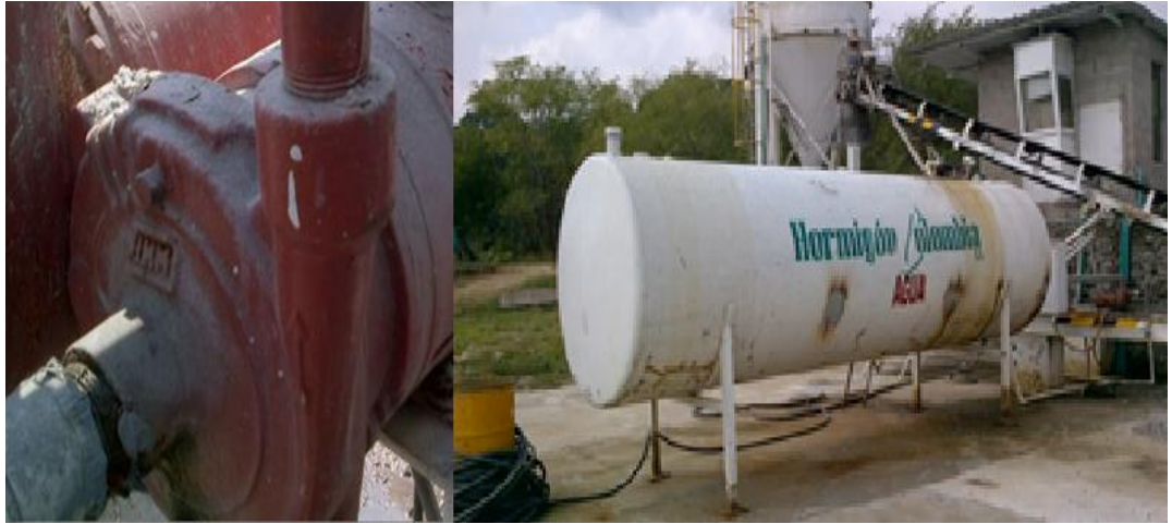
Figura 25. Tanque de almacenamiento y bomba de alimentación
