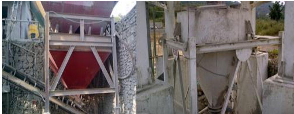
Figura 23. Báscula de agregados y cemento
