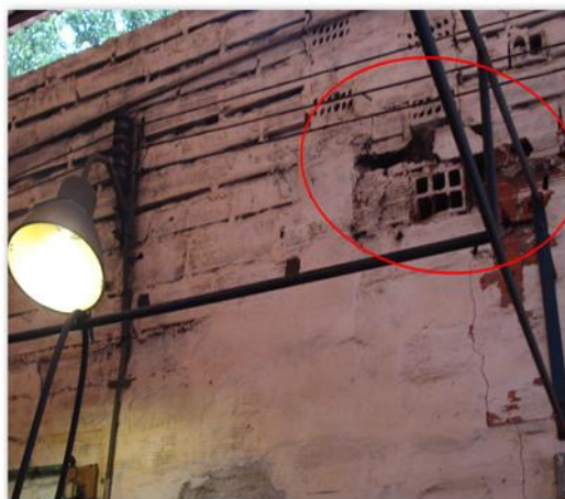
Ilustración 111. Paredes en mal estado.
