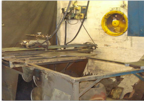
Ilustración 126. Extractor y acometidas eléctricas
