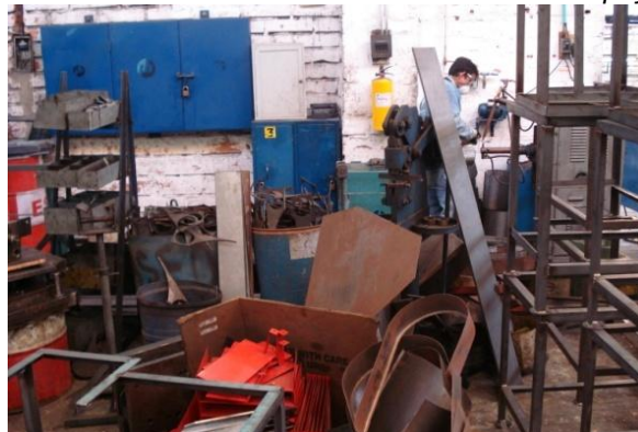
Ilustración 123. Único extintor en la unidad de apoyo
