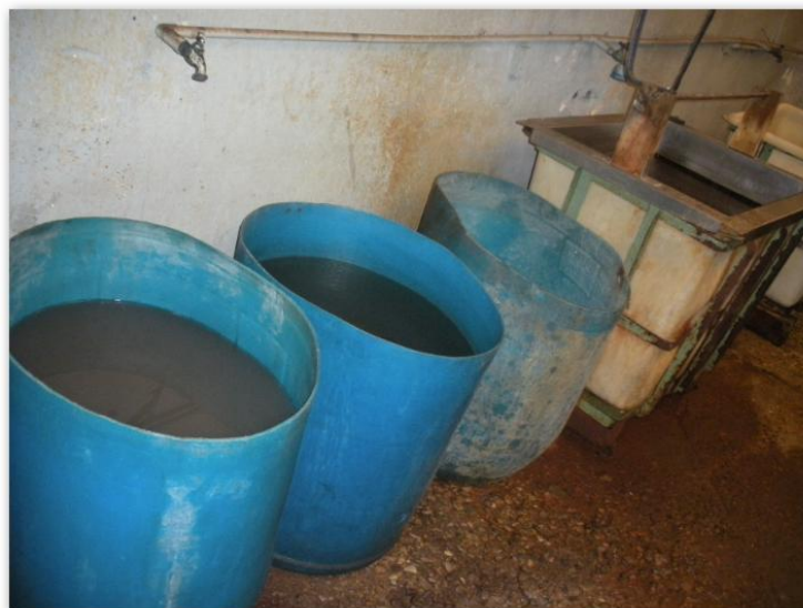
Ilustración 132. Canecas, paredes y piso en mal estado
