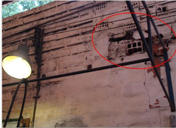
Ilustración 68. Paredes en mal estado.
