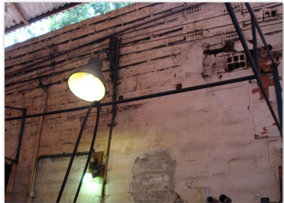
Ilustración 122. Pared en mal estado
