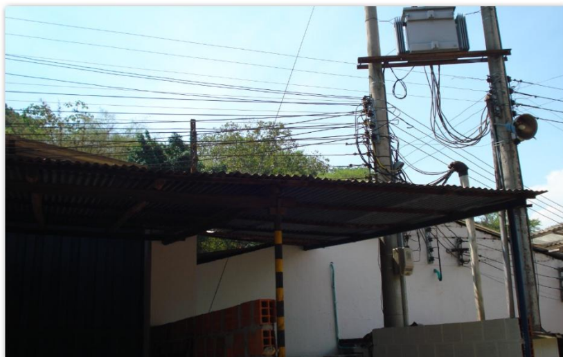
Ilustración 140. Líneas de alta tensión
