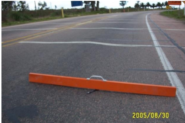
Imagen 7: Ejemplo de ahuellamiento en pavimentos
