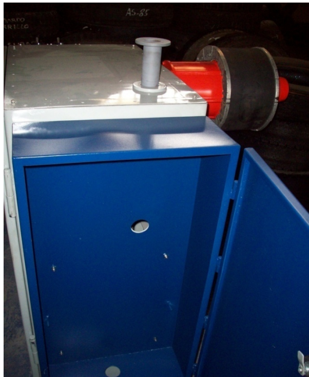
Figura 98. Caja para los contactores
