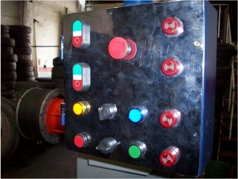
Figura 65. Caja de controles
