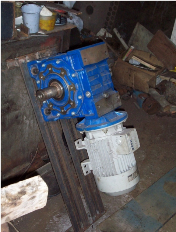
Figura 80. Estructura y posición del moto-reductor en la cabina
