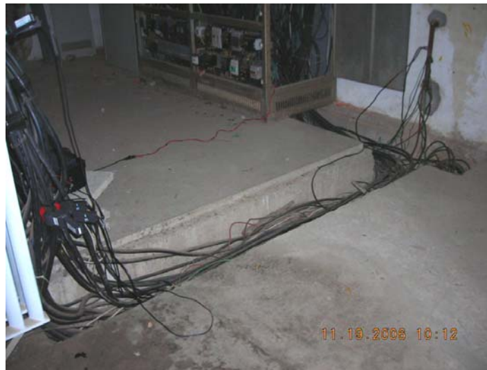
Figura 3.34. Cárcamo, subestación Laboratorios Livianos
