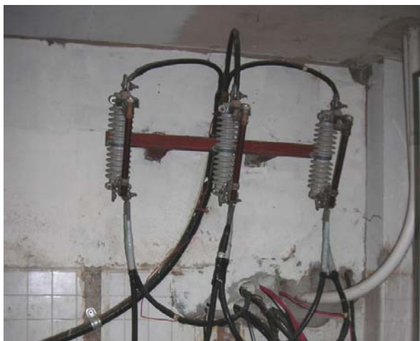
Figura 3.79. Caja cortacircuitos, Sótano Administración
