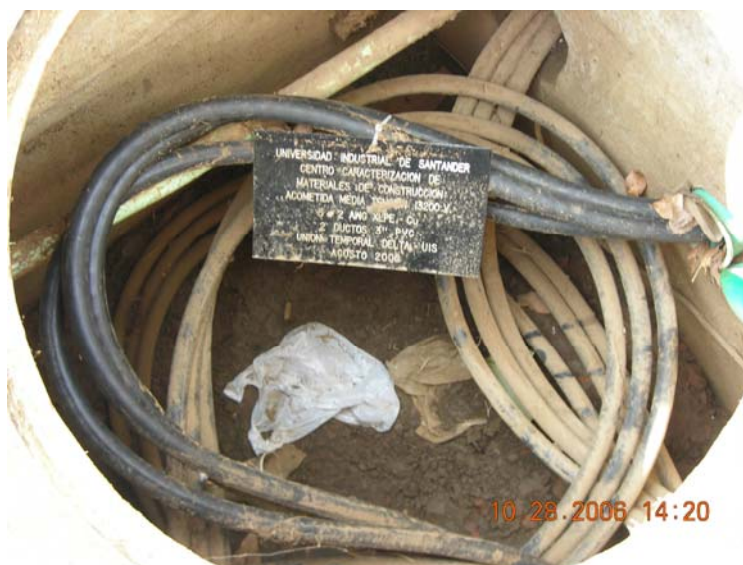
Figura 4.1. Caja de inspección 1, tramo Eléctrica Antigua – Laboratorios de Caracterización
