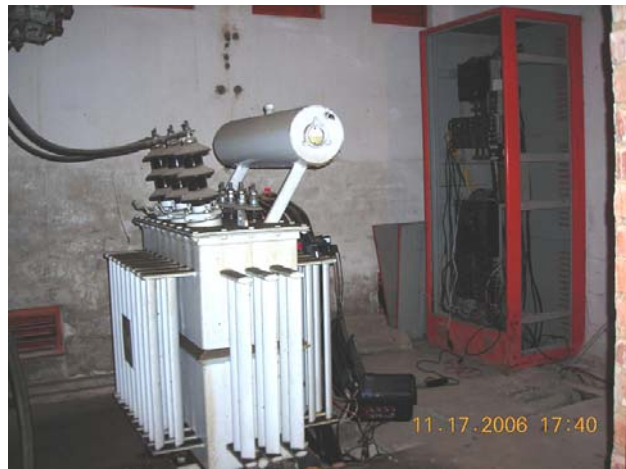
Figura 3.26. Subestación Planta de Aceros
