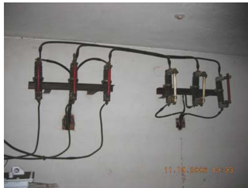
Figura 3.32. Cajas cortacircuitos, subestación Laboratorios Livianos
