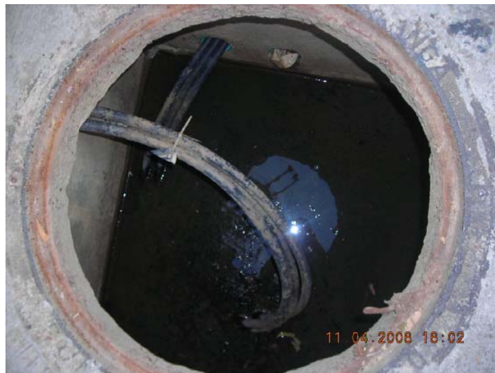
Figura 4.18. Caja de inspección 1, tramo Poste Carrera 30 – Coliseo
