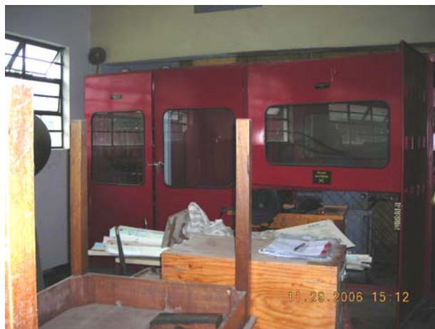
Figura 3.2. Subestación Eléctrica Antigua
