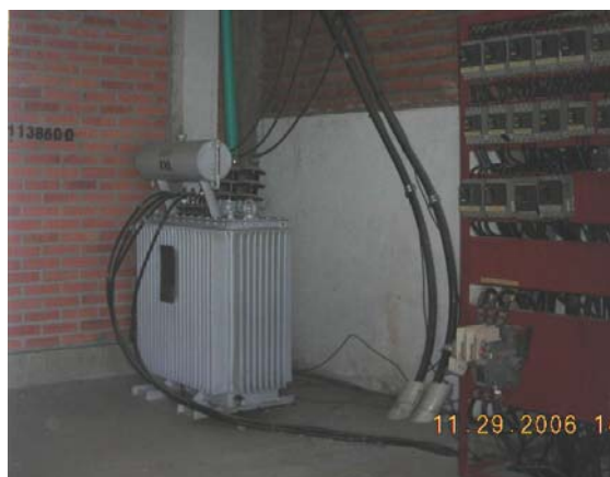
Figura 3.41. Subestación Ingeniería Mecánica
