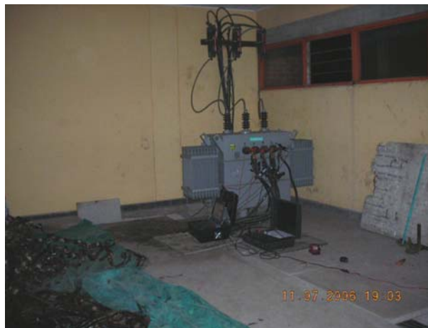
Figura 3.9. Subestación Ingeniería Civil
