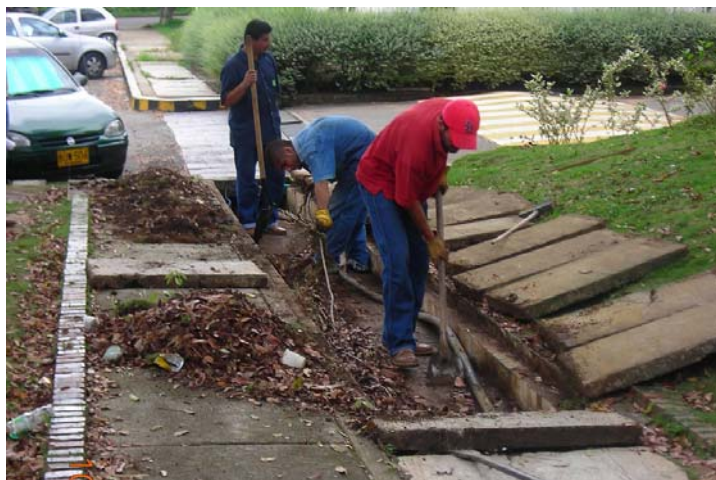
Figura 4.4. Cárcamo de la acometida Eléctrica Antigua – Ingeniería Civil
