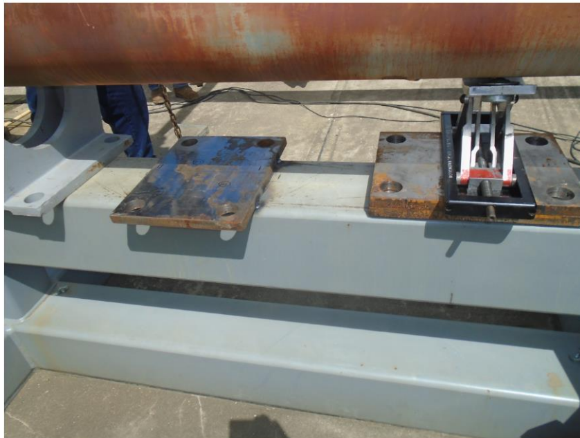
Figura 26. Trabajos de soldadura para ajustes de puntos de apoyo de las secciones de bomba.
