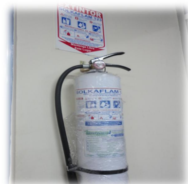
Imagen 5. Extintor área administrativa
