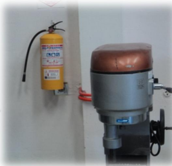
Imagen 8. Extintor en el área de mezclado
