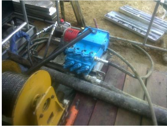
Figura 2. Bomba de suministro de agua (Fuera de servicio). Fuente. Departamento de operaciones.
