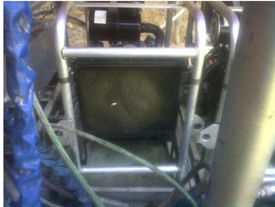
Figura 3. Motor diésel (Fallas por temperatura). Fuente. Departamento de operaciones.
