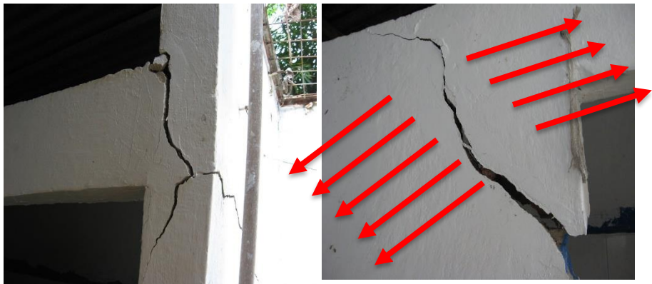
Figura 50. Localización de falla en conexiones de vivienda en el área metropolitana de Santander afectada por el sismo del 10 de marzo del 2015. Adaptado: Alcaldía de Floridablanca (Floridablanca. 2015). Galería Fotográfica del reporte de daños provocados por el sismo del 10 de marzo del 2015. Floridablanca-Santander.
