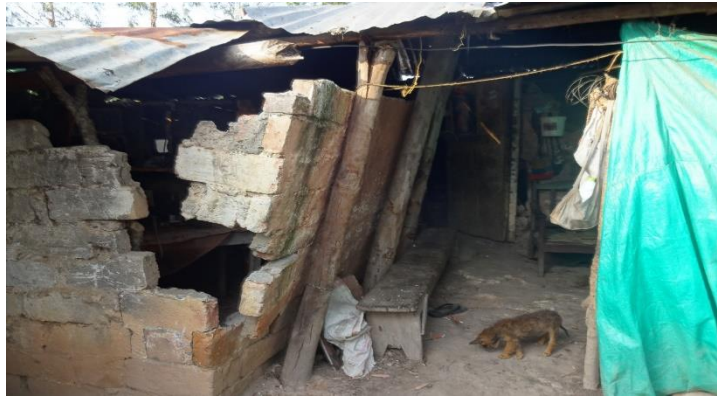
Figura 102. Evidencia del estado de las edificaciones después del sismo del 10 de marzo del 2015 en Los Santos Santander, casa parcialmente destruida después del sismo.
