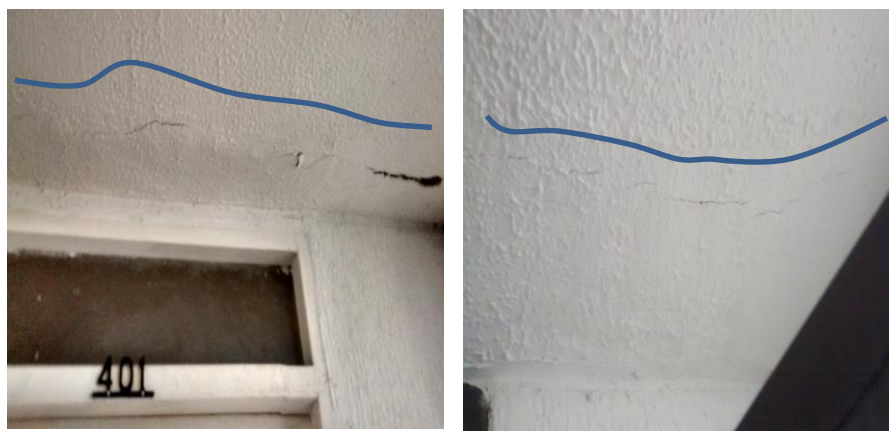
Figura 35. Edificio OMAGA II afectado por el sismo del 10 de marzo del 2015 presentando grietas en las placas
