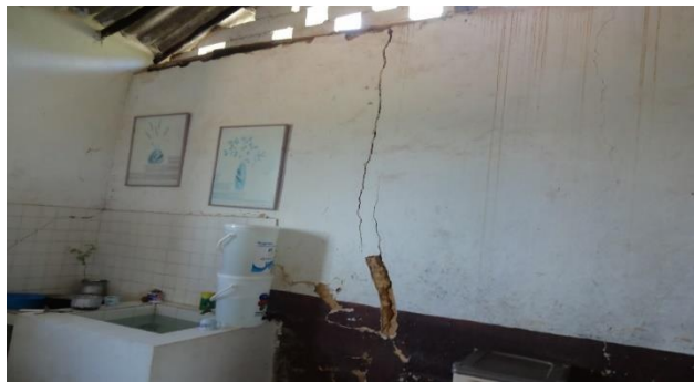
Figura 94. Evidencia del estado de las edificaciones después del sismo del 10 de marzo del 2015 en Los Santos Santander, grieta en muro de tapia pisada.
