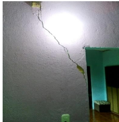
Figura 62. Grieta inclinada en muro de mampostería de vivienda afectada.
