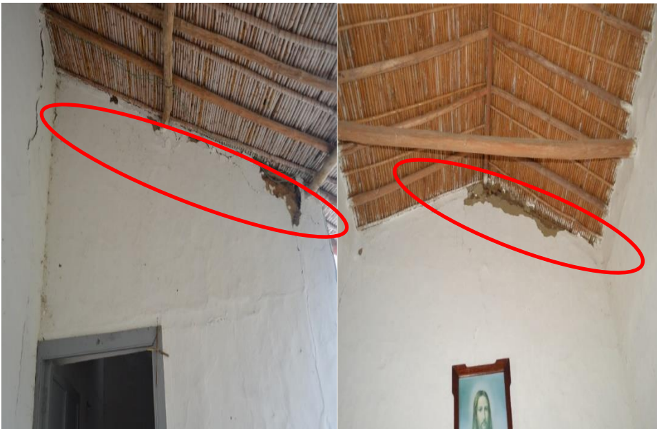
Figura 67. Daños en Muros por la falta de diseño de cubierta y sus respectivas conexiones.
