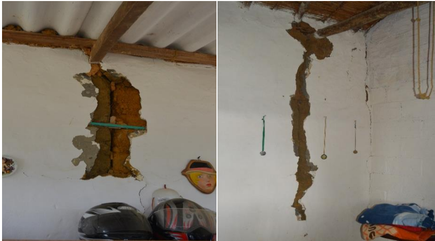
Figura 68. Daños severos en Muros de tapia pisada en vivienda de Betulia por el sismo del 10 de marzo del 2015 Adaptado: Alcaldía de Betulia (2015). Galería Fotográfica 10 de marzo del 2015. Floridablanca-Santander
