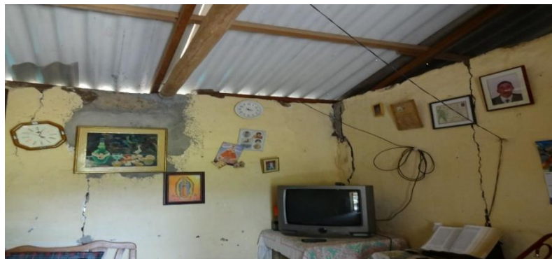
Figura 98. Evidencia del estado de las edificaciones después del sismo del 10 de marzo del 2015 en Los Santos Santander, grietas verticales en muro de tapia pisada que había sido reparado con anterioridad al suceso.
