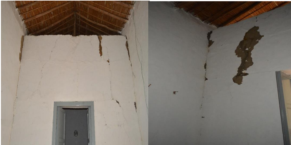
Figura 66. Evidencias de daños en conexiones y muros de tapia pisada en una edificación de Betulia Santander.
