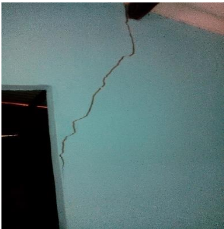
Figura 58. Grietas en Muro de mampostería debido a esa sobre esfuerzos. Adaptado: Alcaldía de Betulia (2015). Galería Fotográfica del reporte de daños provocados por el sismo del 10 de marzo del 2015. Floridablanca-Santander.
