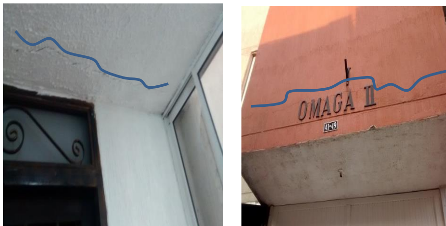
Figura 36. Edificio OMAGA II afectado por el sismo del 10 de marzo del 2015 presentando grietas en las placas y en los muros.
