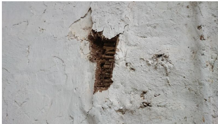
Figura 84. Evidencia del estado de las edificaciones después del sismo del 10 de marzo del 2015 en Betulia Santander, falla en muro de tapia pisada con refuerzo en madera.
