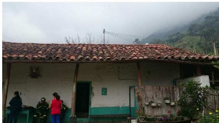
Figura 77. Evidencia del estado de las edificaciones después del sismo del 10 de marzo del 2015 en Betulia Santander, se observa la mala calidad del diseño y materiales de la estructura. Adaptado: Alcaldía de Betulia (2015). Galería Fotográfica 10 de marzo del 2015. Floridablanca-Santander
