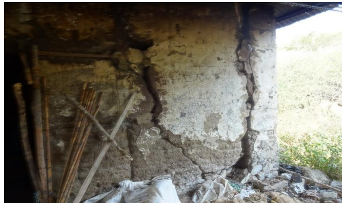
Figura 100 . Evidencia del estado de las edificaciones después del sismo del 10 de marzo del 2015 en Los Santos Santander, rasgos de humedad y deterioro del material, grietas de tamaño significativo.
