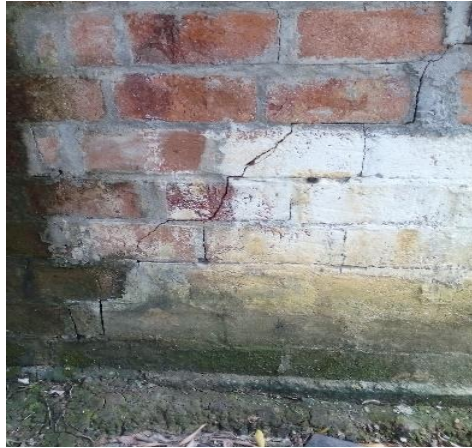
Figura 59. Grieta inclinada en ladrillo de mampostería.
