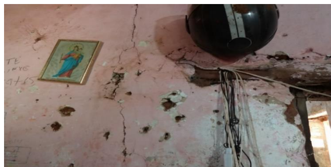
Figura 92. Evidencia del estado de las edificaciones después del sismo del 10 de marzo del 2015 en Los Santos-Santander, Daños en muro interno de tapia pisada.
