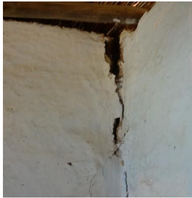
Figura 85. Evidencia del estado de las edificaciones después del sismo del 10 de marzo del 2015 en Los Santos-Santander, Muros de tapia pisada desprendiéndose por falta de conexiones.
