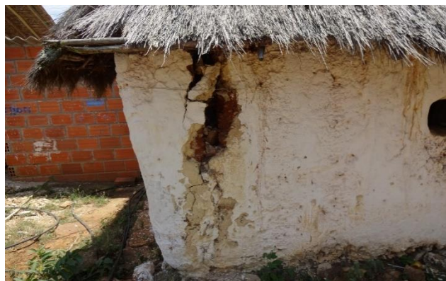
Figura 89. Evidencia del estado de las edificaciones después del sismo del 10 de marzo del 2015 en Los Santos-Santander, Muro que falla por deflexión perpendicular al plano en las esquinas no confinadas de muros sueltos.
