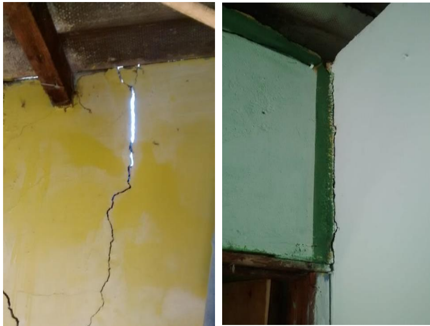
Figura 34. Vivienda de Bucaramanga ubicada en la calle 69 # 8ª 35 afectada por grietas en las uniones debido al sismo del 10 de marzo del 2015.
