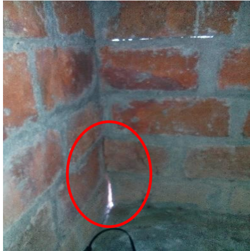
Figura 63. Fisura en conexión entre muros de mampostería en vivienda afectada. Adaptado: Alcaldía de Betulia (2015). Galería Fotográfica 10 de marzo del 2015. Floridablanca-Santander
