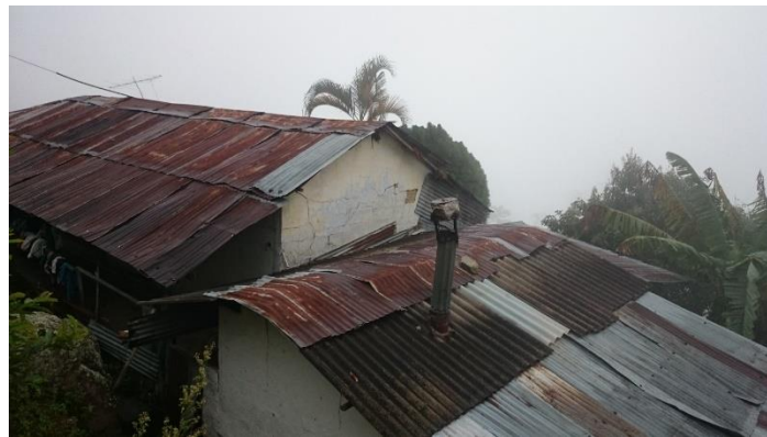
Figura 82. Evidencia del estado de las edificaciones después del sismo del 10 de marzo del 2015 en Betulia Santander, se observan grietas en muro del segundo piso de edificación
