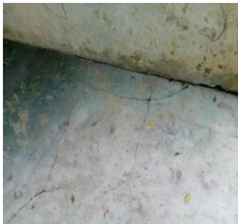
Figura 65. Grietas en losa de concreto. Adaptado: Alcaldía de Betulia (2015). Galería Fotográfica 10 de marzo del 2015. Floridablanca-Santander
