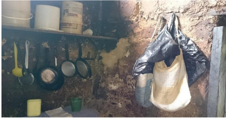
Figura 75. Evidencia del estado de las edificaciones después del sismo del 10 de marzo del 2015 en Betulia Santander, se observa la mala calidad del diseño y materiales de la estructura. Adaptado: Alcaldía de Betulia (2015). Galería Fotográfica 10 de marzo del 2015. Floridablanca-Santander
