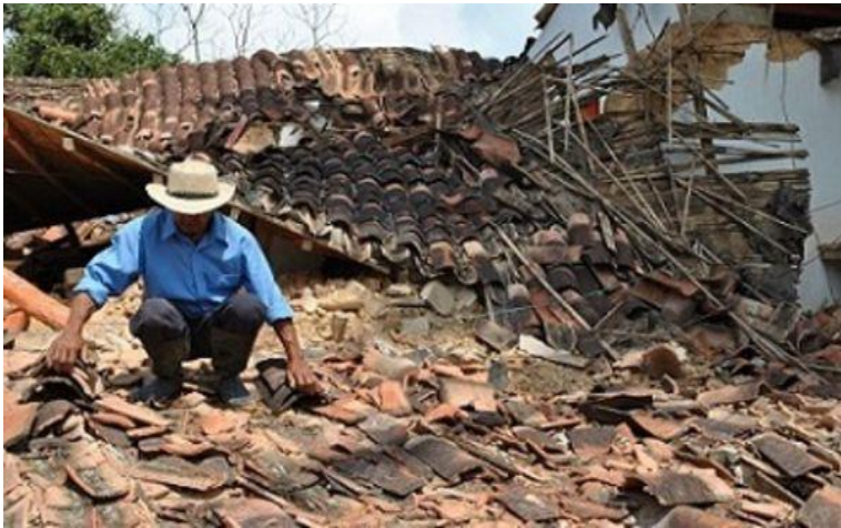
Figura 29. Casa totalmente destruida por el sismo del 10 de marzo del 2015. Adaptado: Alcaldía de Rionegro (Rionegro,.2015). Galería Fotográfica del reporte de daños provocados por el sismo del 10 de marzo del 2015. Rionegro-Santander.
