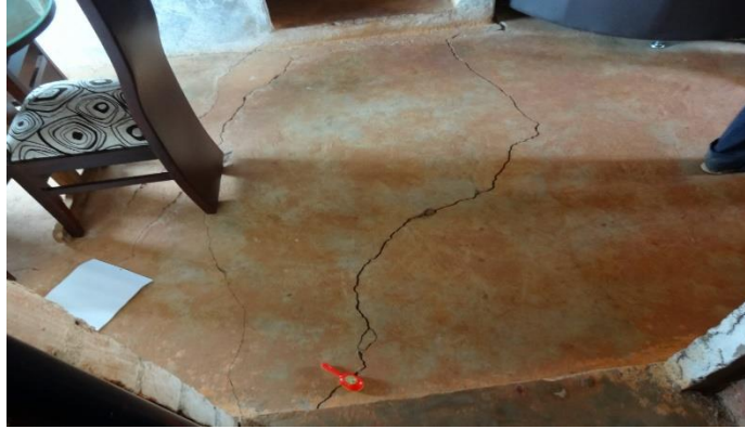
Figura 96. Evidencia del estado de las edificaciones después del sismo del 10 de marzo del 2015 en Los Santos Santander, grietas en losa interior de vivienda.
