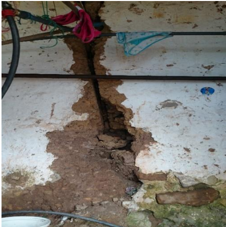
Figura 72. Grietas y señales de deterioro en la edificación de tapia pisada en Betulia. Adaptado: Alcaldía de Betulia (2015). Galería Fotográfica 10 de marzo del 2015. Floridablanca-Santander
