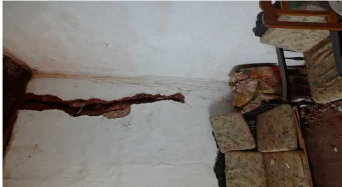
Figura 93. Evidencia del estado de las edificaciones después del sismo del 10 de marzo del 2015 en Los Santos Santander, Grieta en muro de tapia pisada con pérdida de relleno significativa.
