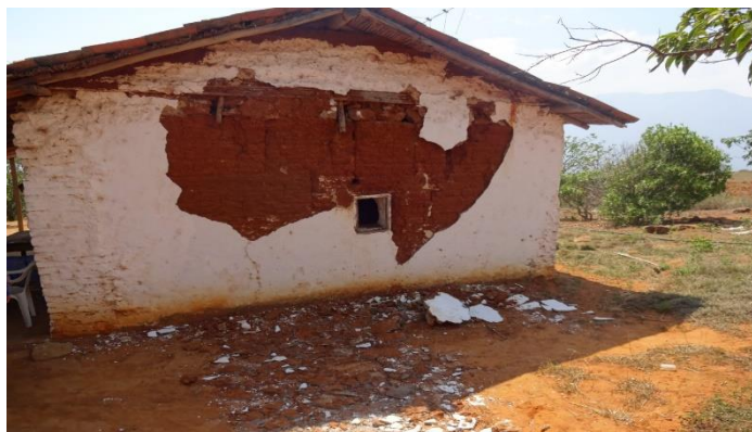
Figura 95. Evidencia del estado de las edificaciones después del sismo del 10 de marzo del 2015 en Los Santos Santander, perdida de recubrimiento y relleno del 50% del muro exterior de tapia pisada.
