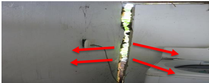
Figura 51. Desprendimiento de muros en vivienda en el área metropolitana de Bucaramanga. Adaptado: Alcaldía de Floridablanca (Floridablanca. 2015). Galería Fotográfica del reporte de daños provocados por el sismo del 10 de marzo del 2015. Floridablanca-Santander.
