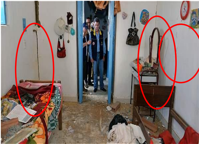
Figura 28. Casa afectada Rionegro Santander por el sismo del 10 de marzo del 2015. Adaptado: Alcaldía de Rionegro (Rionegro,.,2015). Galería Fotográfica del reporte de daños provocados por el sismo del 10 de marzo del 2015. Rionegro-Santander.
