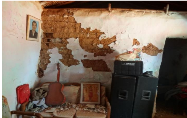
Figura 90. Evidencia del estado de las edificaciones después del sismo del 10 de marzo del 2015 en Los Santos-Santander, daños en muro interior de tapia pisada y madera, con pérdida de material.
