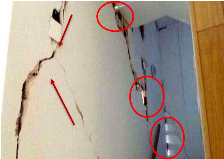
Figura 32. Edificación de la ciudad de Bucaramanga afectada por el sismo del 10 de marzo del 2015. Adaptado: Alcaldía de Floridablanca (Floridablanca. 2015). Galería Fotográfica del reporte de daños provocados por el sismo del 10 de marzo del 2015. Floridablanca-Santander.
