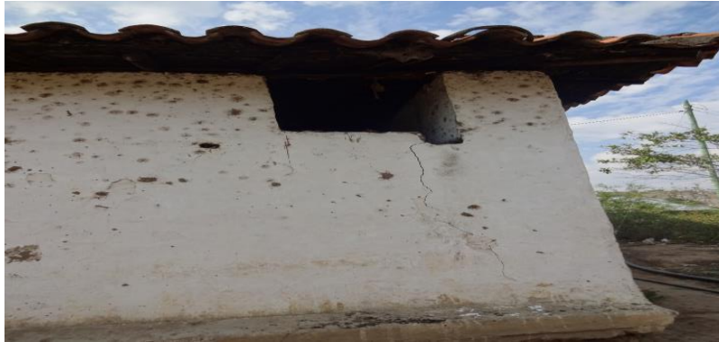
Figura 99. Evidencia del estado de las edificaciones después del sismo del 10 de marzo del 2015 en Los Santos Santander, se observa deterioro en muro de tapia debido a la calidad del material y grietas ocasionadas por el sismo.
