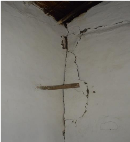
Figura 70. Grietas y fallas en muro de tapia pisada en conexiones entre estos. Adaptado: Alcaldía de Betulia (2015). Galería Fotográfica 10 de marzo del 2015. Floridablanca-Santander
