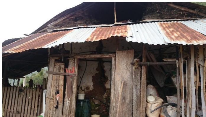
Figura 80. Evidencia del estado de las edificaciones después del sismo del 10 de marzo del 2015 en Betulia Santander, estado del suelo luego del sismo. Adaptado: Alcaldía de Betulia (2015). Galería Fotográfica 10 de marzo del 2015. Floridablanca-Santander.
