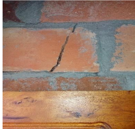
Figura 60. Grieta inclinada en muro de mampostería de vivienda afectada.
