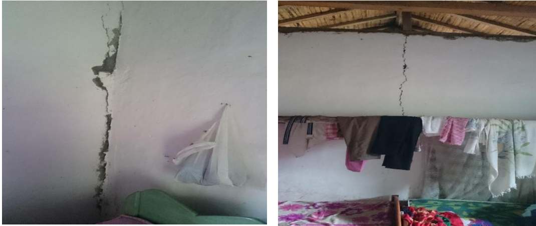
Figura 71. Se presentan grietas verticales en los muros de tapia pisada en el municipio de Betulia. Adaptado: Alcaldía de Betulia (2015). Galería Fotográfica 10 de marzo del 2015. Floridablanca-Santander
