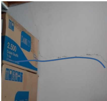
Figura 45. Grietas Horizontales en los muros en San Andresito Centro Bucaramanga. Adaptado: Alcaldía de Floridablanca (Floridablanca. 2015). Galería Fotográfica del reporte de daños provocados por el sismo del 10 de marzo del 2015. Floridablanca-Santander.
