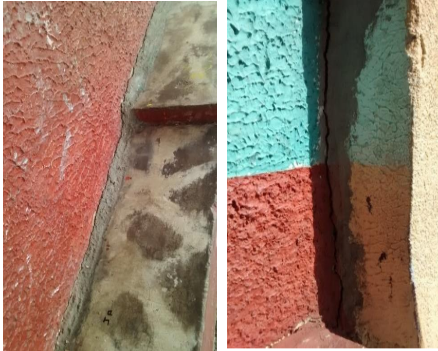
Figura 33. Vivienda de Bucaramanga ubicada en la calle 69 # 8ª 35 afectada por grietas en las uniones debido al sismo del 10 de marzo del 2015.
