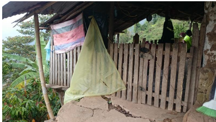
Figura 79. Evidencia del estado de las edificaciones después del sismo del 10 de marzo del 2015 en Betulia Santander, estado del suelo luego del sismo Adaptado: Alcaldía de Betulia (2015). Galería Fotográfica 10 de marzo del 2015. Floridablanca-Santander
