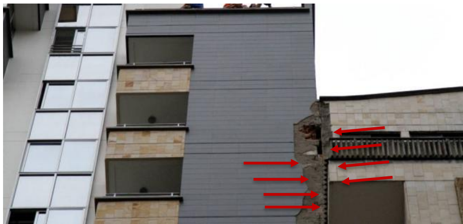
Figura 31. Edificación afecta en barrio Comuneros, en la carrera 19# 8-45 por el sismo del 10 de marzo del 2015
