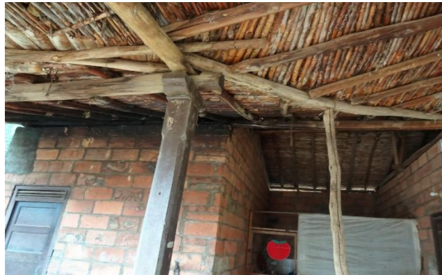
Figura 91. Evidencia del estado de las edificaciones después del sismo del 10 de marzo del 2015 en Los Santos-Santander, se observa falta de diseño estructural en la cubierta y muros de ladrillo sin confinamiento.
