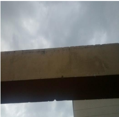
Figura 42. Grietas Horizontal en Viga de la edificación Héroes del silencio de Bucaramanga.. Adaptado: Alcaldía de Floridablanca (Floridablanca. 2015). Galería Fotográfica del reporte de daños provocados por el sismo del 10 de marzo del 2015. Floridablanca-Santander.
