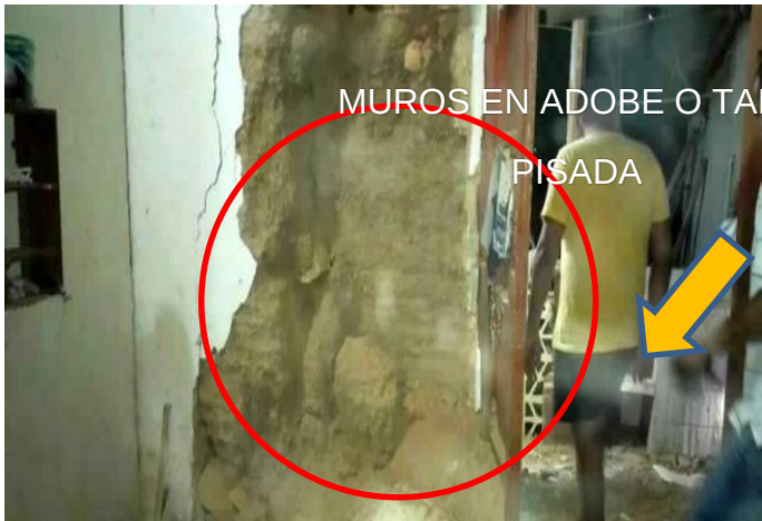
Figura 27.Casa afectada Rionegro Santander por el sismo del 10 de marzo del 2015. Adaptado: Alcaldía de Rionegro (Rionegro,.,2015). Galería Fotográfica del reporte de daños provocados por el sismo del 10 de marzo del 2015. Rionegro-Santander.
