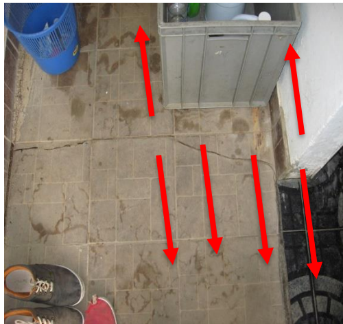
Figura 54. Grieta en la losa del piso causada por sobreesfuerzos ejercidos por la tierra.
