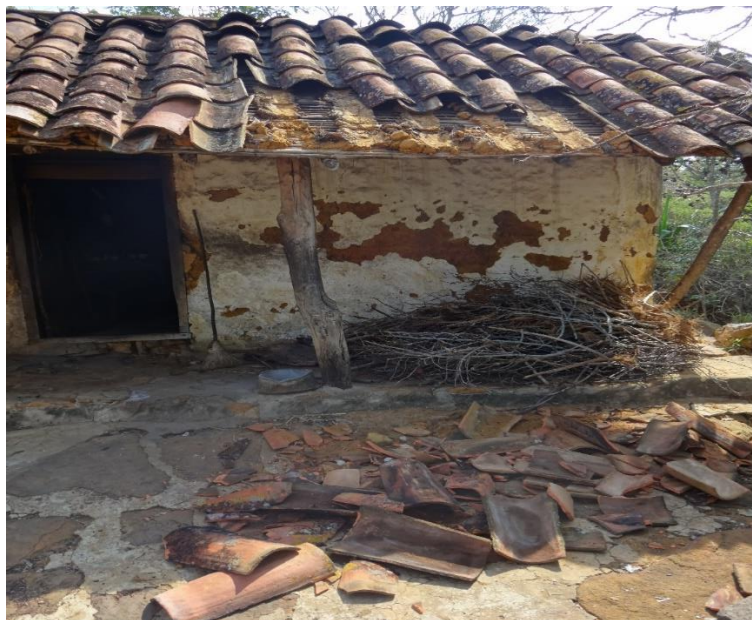
Figura 19. Edificación en Tapia pisada afectada en la Mesa de los Santos por el sismo del 10 de marzo del 2015. Adaptado: Alcaldía de Los Santos (2015). Acta Diligencia de Demolición Sobre Vivienda No Habitable y en Estado de Ruina. Los Santos-Santander.
