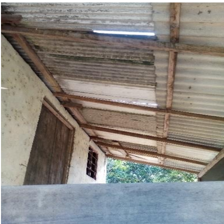
Figura 57 . Evidencia de daño en la cubierta de la vivienda. Adaptado: Alcaldía de Betulia (2015). Galería Fotográfica del reporte de daños provocados por el sismo del 10 de marzo del 2015. Floridablanca-Santander.
