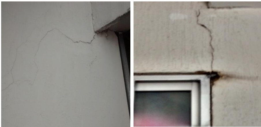
Figura 47. Edificio en sistema de pórtico afectado por el sismo del 10 de marzo del 2015 presentando grietas. Adaptado: Alcaldía de Floridablanca (Floridablanca. 2015). Galería Fotográfica del reporte de daños provocados por el sismo del 10 de marzo del 2015. Floridablanca-Santander.
