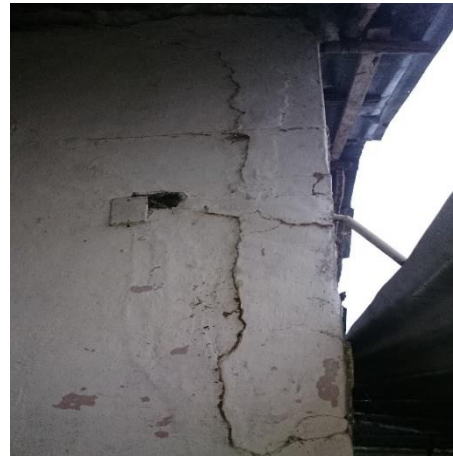
Figura 73. Grietas verticales al borde el Muro en Tapia en Betulia. Adaptado: Alcaldía de Betulia (2015). Galería Fotográfica 10 de marzo del 2015. Floridablanca-Santander
