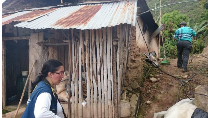
Figura 81. Evidencia del estado de las edificaciones después del sismo del 10 de marzo del 2015 en Betulia Santander, falla en muro de tapia pisada con pérdida significativa de relleno, se observa la mala calidad del diseño y materiales de la estructura.
