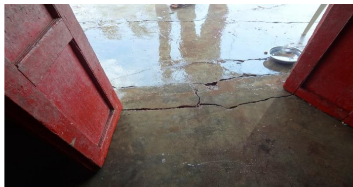
Figura 101. Evidencia del estado de las edificaciones después del sismo del 10 de marzo del 2015 en Los Santos Santander, grietas en losa interior de vivienda.
