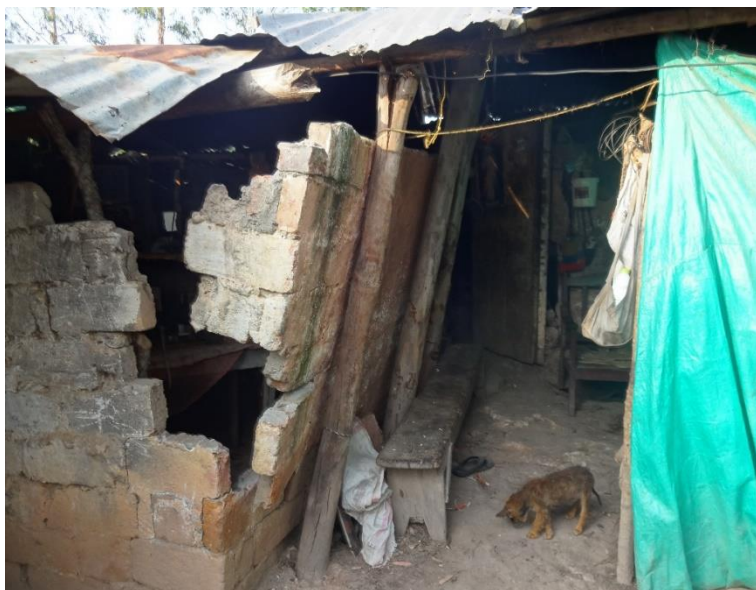
Figura 20. Edificación en Mampostería no confinada afectada en la Mesa de los Santos por el sismo del 10 de marzo del 2015. Adaptado: Alcaldía de Los Santos (2015). Acta Diligencia de Demolición Sobre Vivienda No Habitable y en Estado de Ruina. Los Santos-Santander.
