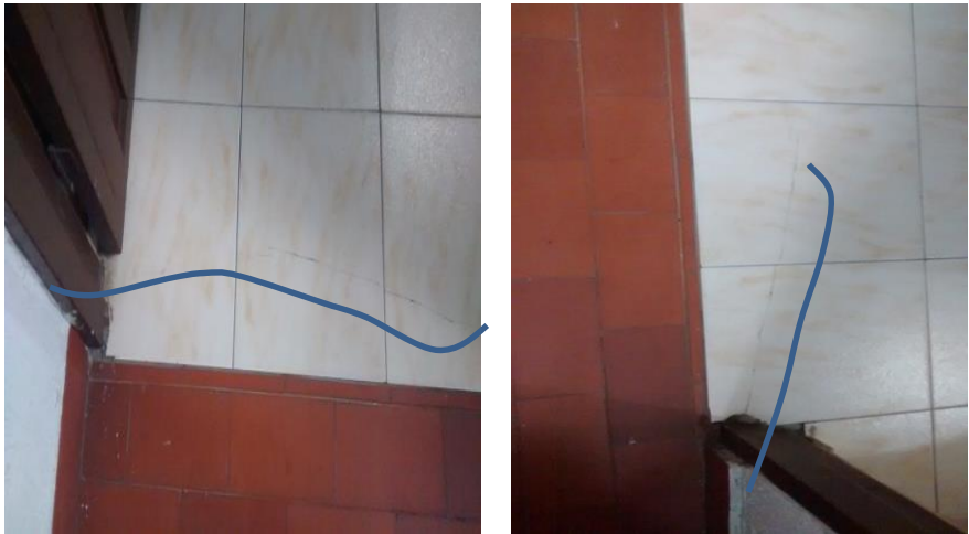
Figura 38. Edificio OMAGA II afectado por el sismo del 10 de marzo del 2015 presentando grietas en las placas y en los muros. Adaptado: Alcaldía de Floridablanca (Floridablanca. 2015). Galería Fotográfica del reporte de daños provocados por el sismo del 10 de marzo del 2015. Floridablanca-Santander.
