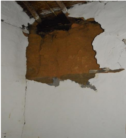
Figura 69. Muro de tapia parcialmente colapsado por conexiones con elementos de madera. Adaptado: Alcaldía de Betulia (2015). Galería Fotográfica 10 de marzo del 2015. Floridablanca-Santander
