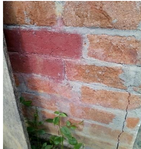
Figura 64. Grieta vertical en muro de mampostería. Adaptado: Alcaldía de Betulia (2015). Galería Fotográfica 10 de marzo del 2015. Floridablanca-Santander.
