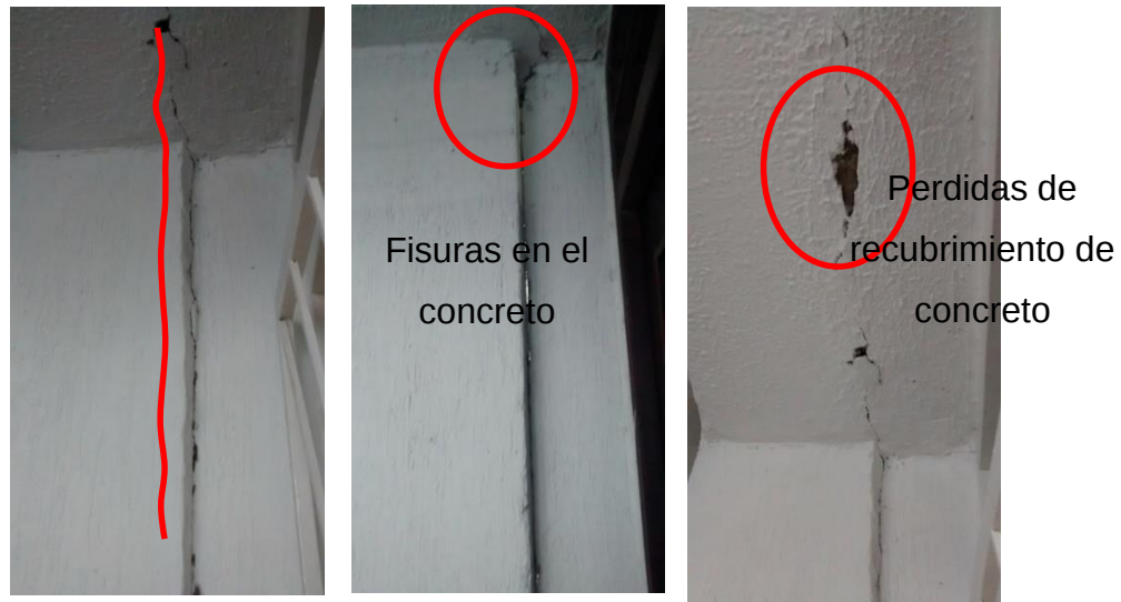
Figura 40. Grietas en Muros de la edificación Héroes del silencio de Bucaramanga. Adaptado: Alcaldía de Floridablanca (Floridablanca. 2015). Galería Fotográfica del reporte de daños provocados por el sismo del 10 de marzo del 2015. Floridablanca-Santander.
