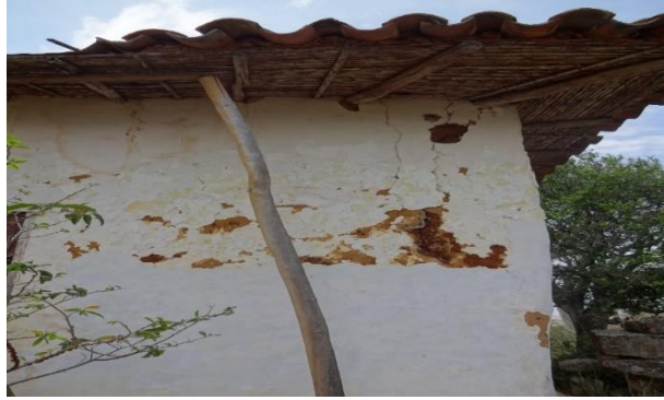
Figura 87. Evidencia del estado de las edificaciones después del sismo del 10 de marzo del 2015 en Los Santos-Santander, efecto en muro de tapia con pérdida de relleno.
