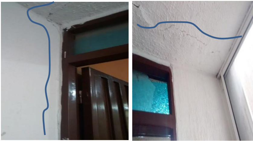
Figura 37. Edificio OMAGA II afectado por el sismo del 10 de marzo del 2015 presentando grietas en las placas y en los muros. Adaptado: Alcaldía de Floridablanca (Floridablanca. 2015). Galería Fotográfica del reporte de daños provocados por el sismo del 10 de marzo del 2015. Floridablanca-Santander.
