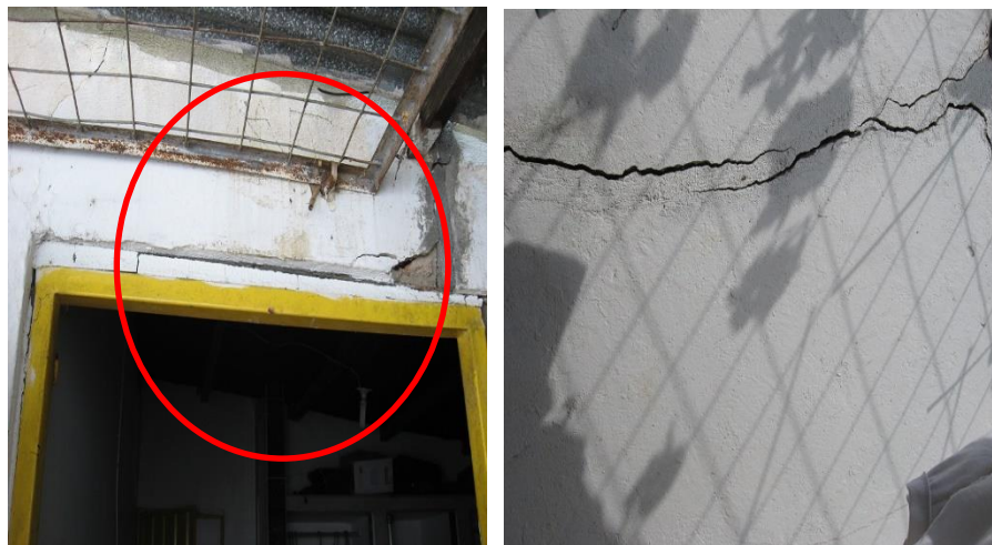
Figura 53. Grietas verticales y horizontales en los muros,
