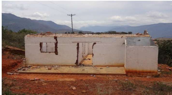
Figura 103. Evidencia del estado de las edificaciones después del sismo del 10 de marzo del 2015 en Los Santos Santander, muros de ladrillo sin confinamiento y conexiones separándose a punto de colapsar.
