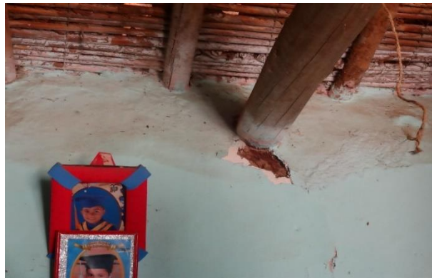
Figura 88. Evidencia del estado de las edificaciones después del sismo del 10 de marzo del 2015 en Los Santos-Santander, efecto en muro de tapia pisada por mala conexión con elemento de cubierta.
