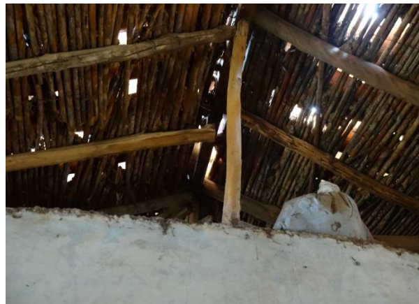
Figura 86. Evidencia del estado de las edificaciones después del sismo del 10 de marzo del 2015 en Los Santos-Santander, efecto en la cubierta por mal diseño de esta.
