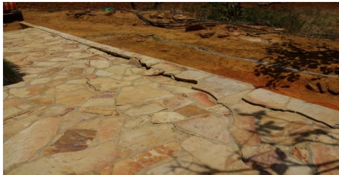
Figura 97. Evidencia del estado de las edificaciones después del sismo del 10 de marzo del 2015 en Los Santos Santander, grietas de losa exterior de vivienda.
