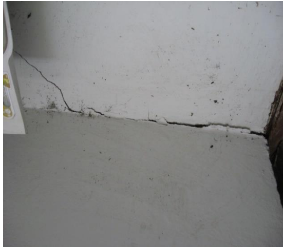
Figura 52. Grieta entre la losa y el muro debido a sobreesfuerzos y malas conexiones.
