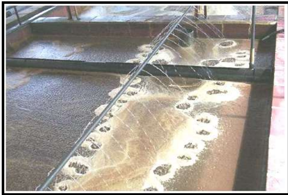
Figura 19. Pozos florentinos ubicados en la zona de trampas de grasa en una planta de benéfico de palma [30].
