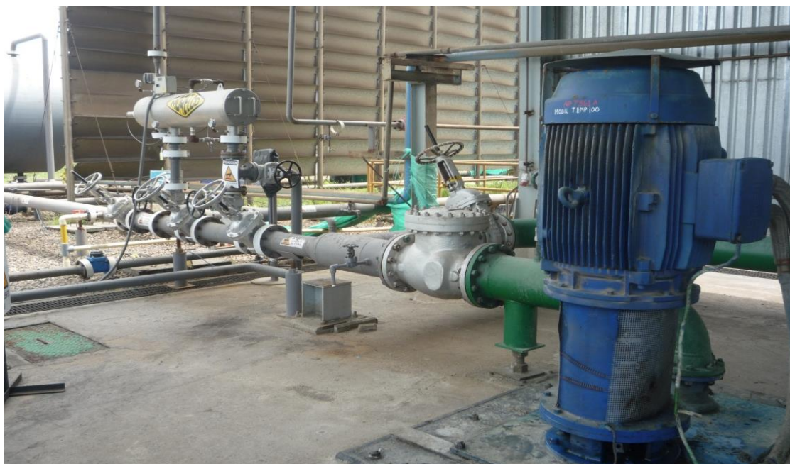
Figura 16. Bomba aspersión AP7361A correspondiente a piscina de aspersión ABA7361 del STAP 1 después de su intervención para la prueba.
