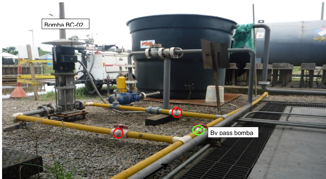
Figura 21. Alineación solución de Dióxido de Cloro hacia agua de producción.
