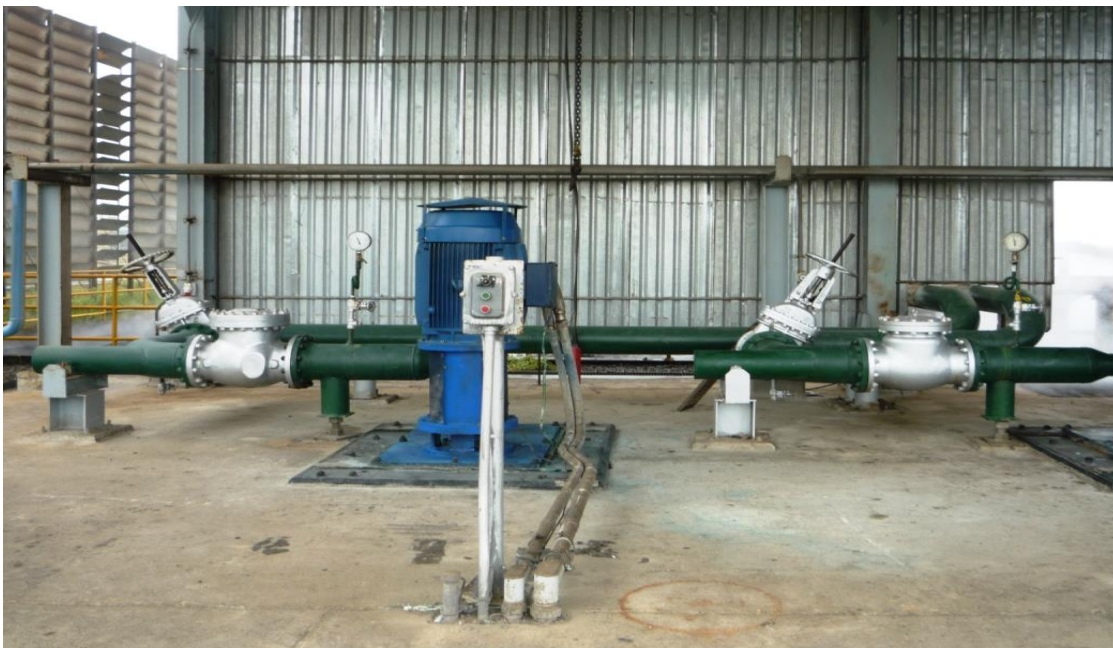
Figura 15. Bomba aspersión AP7361A correspondiente a piscina de aspersión ABA7361 del STAP 1 antes de su intervención.
