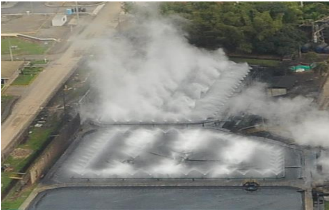
Figura 26. Vista panorámica piscina de aspersión estación Castilla 2
