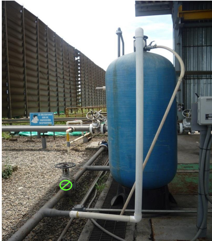
Figura 20. Filtro de arena para agua motivante.
