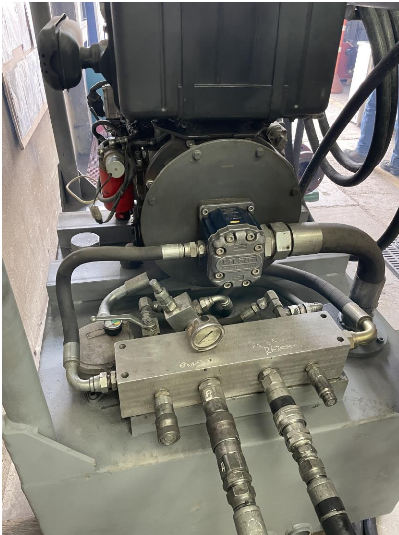
Figura 9. Bomba Hidráulica y Válvula distribuidora
