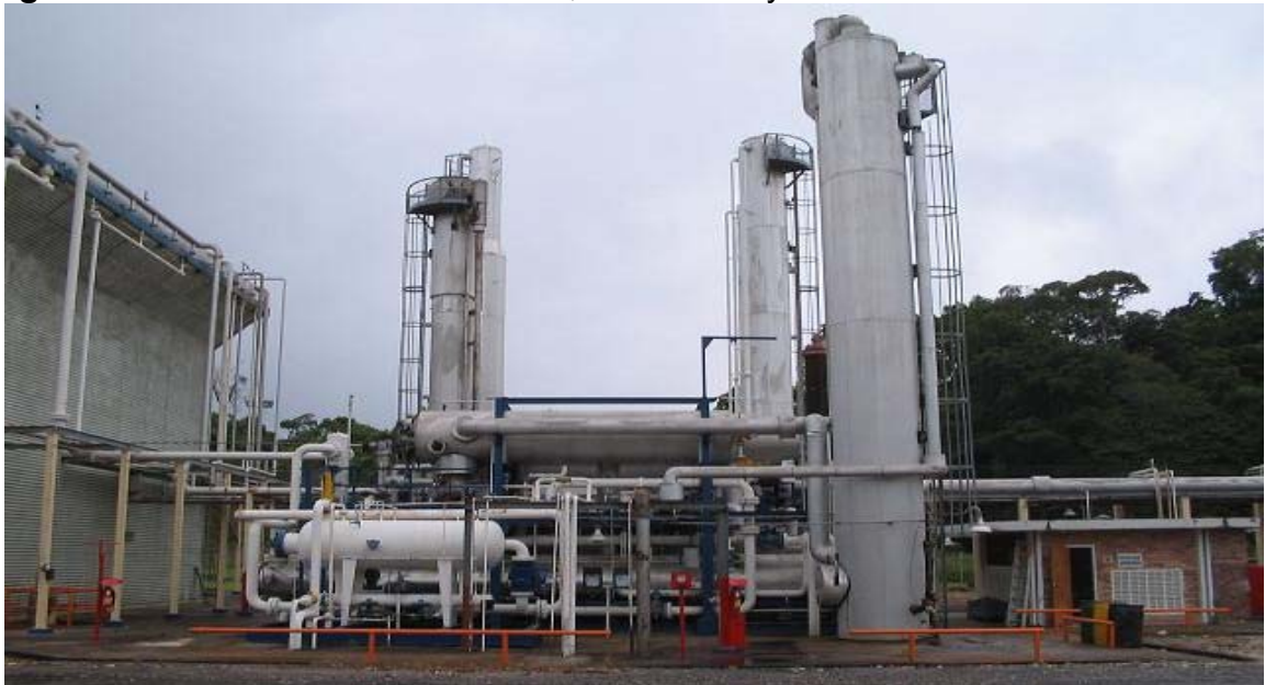
Figura 38. Planta de fraccionamiento, Batería “Payoa”.
