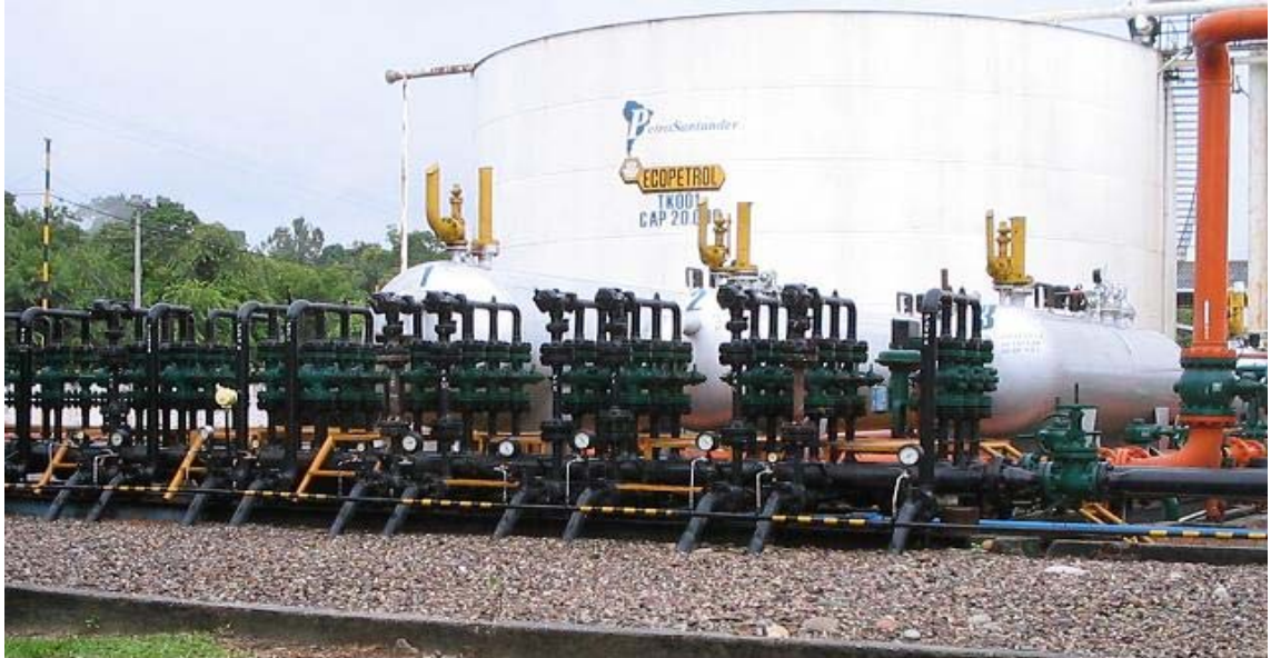
Figura 35. Manifold y Tanques Batería “Payoa.”
