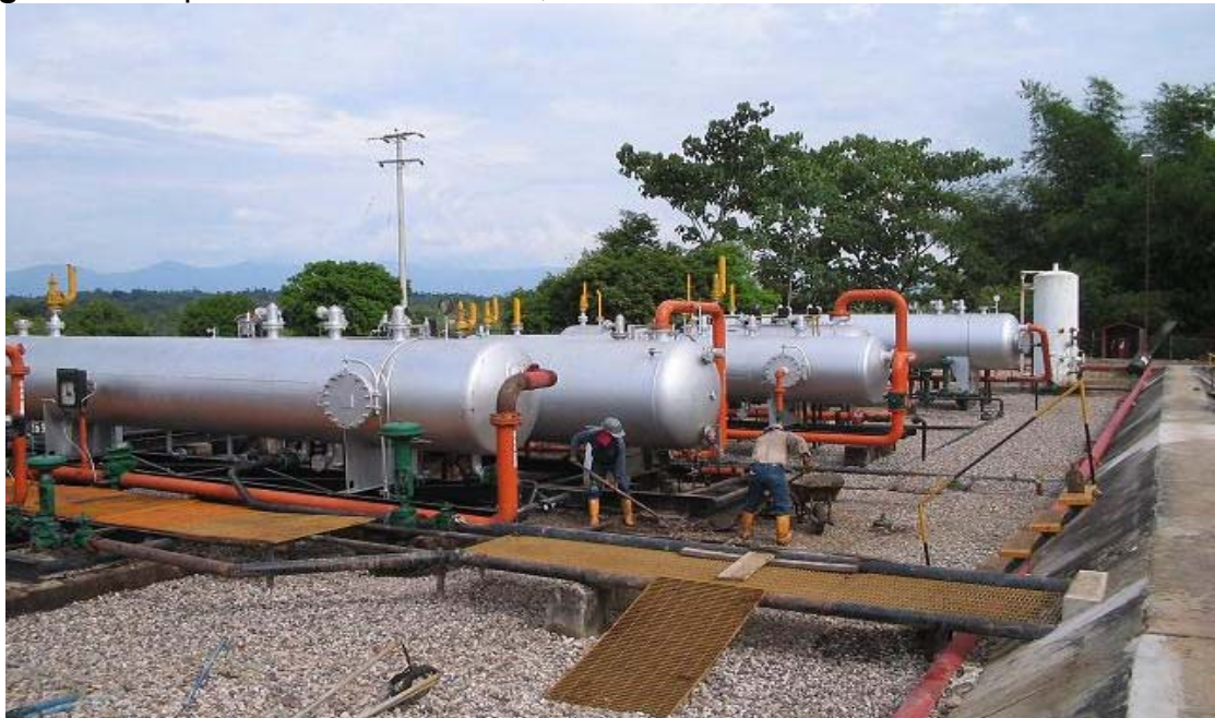
Figura 34. Separadores horizontales, Batería “La Salina”.
