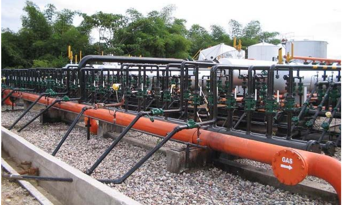
Figura 33. Manifold Batería “La Salina”.
