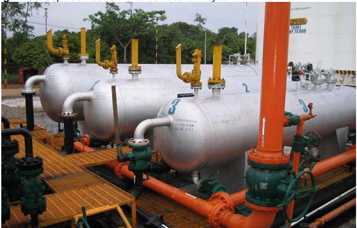
Figura 36. Separadores horizontales Bateria “Payoa”.
