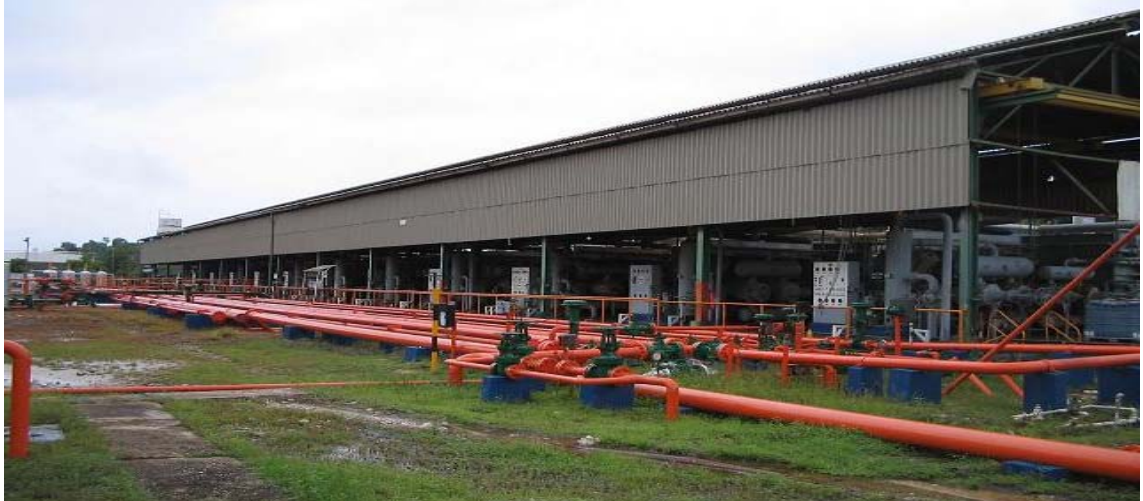
Figura 37. Estación de compresores, Batería “Payoa”.
