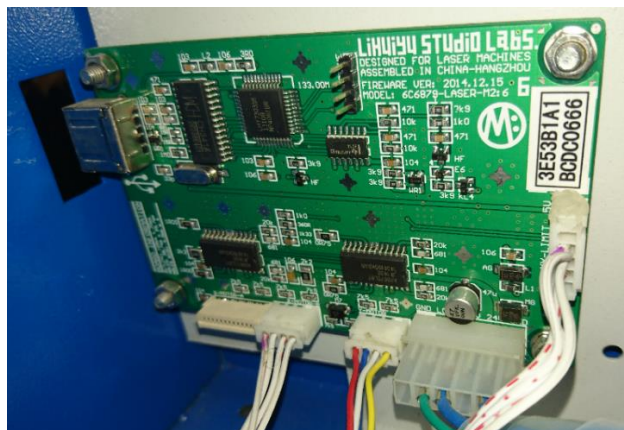
Figura 33. Tarjeta controladora instalada.
