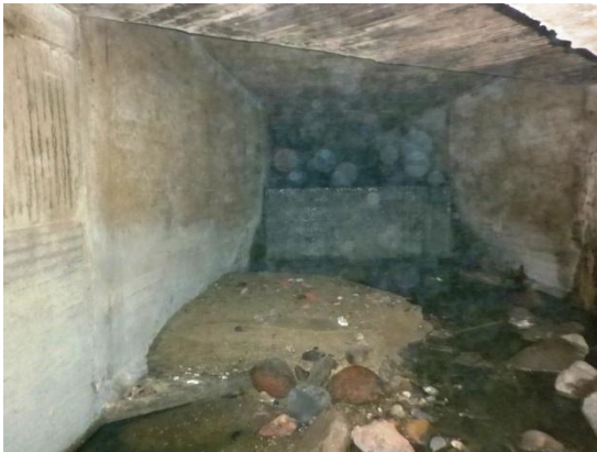
Foto 6. Presencia de sólidos en la estructura de entrega de la puerta del sol.
