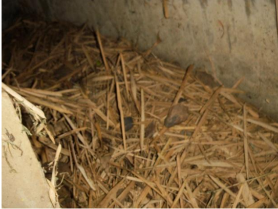
Foto 3. Presencia de sólidos en los sumideros.
