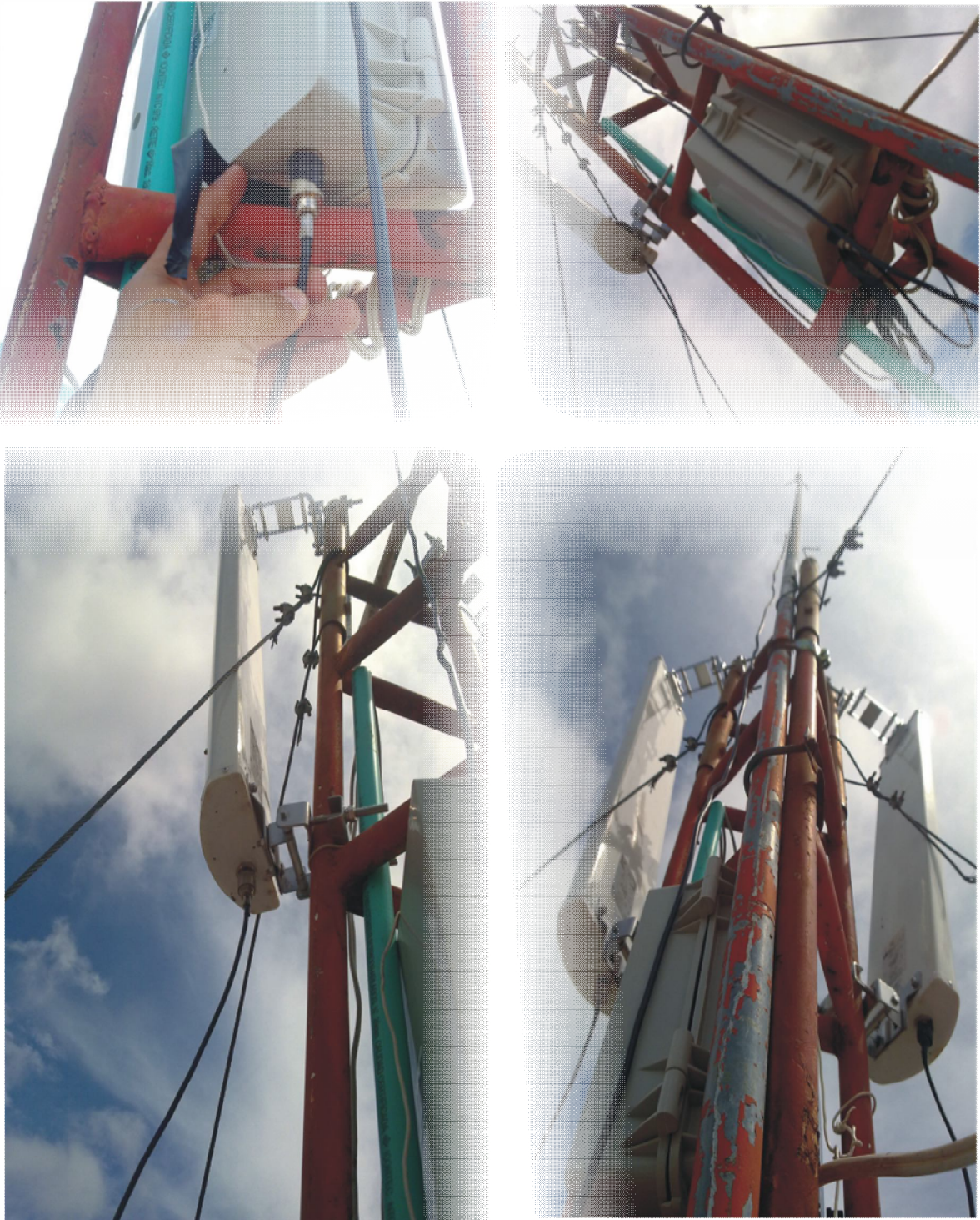
Imagen 232 Configuración de antenas en la Torre de metálica
