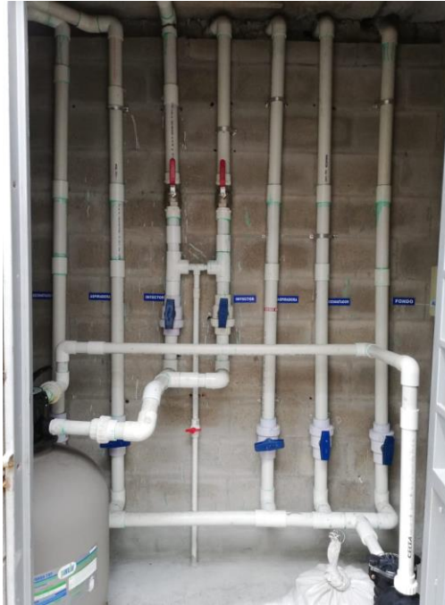
Figura 15. Sistema hidráulico de las piscinas
