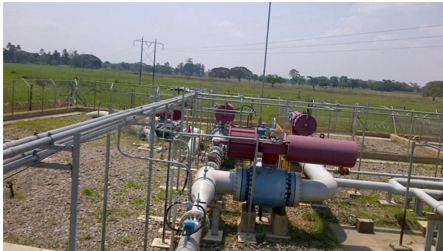
Figura 7 Medidor de flujo, válvula de control de presión, válvulas de corte sistema gasoducto A
