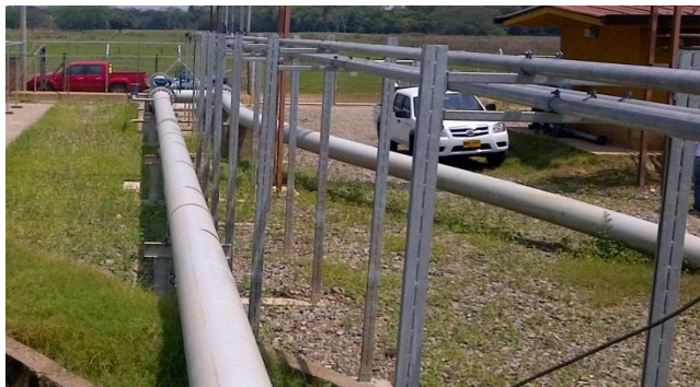
Figura 6 Trampas gasoducto A Cusiana
