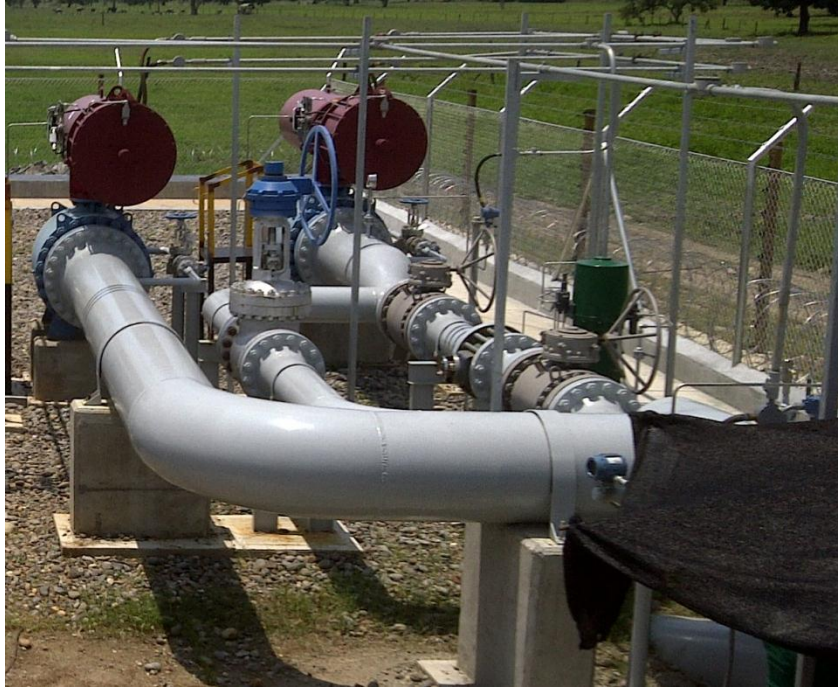
Figura 9 Medidor de flujo, válvula de control de presión, válvulas de corte sistema gasoducto C.
