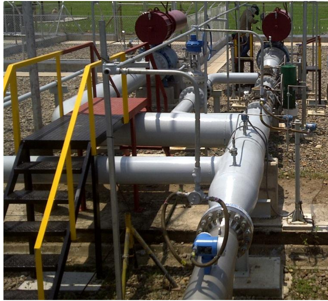
Figura 8 Medidor de flujo, válvula de control de presión, válvulas de corte sistema gasoducto B
