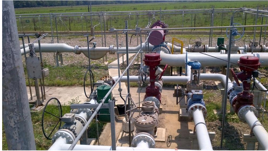
Figura 10 Cuadro de control entre sistemas gasoductos A y C, válvulas HVA-FV-004/005.
