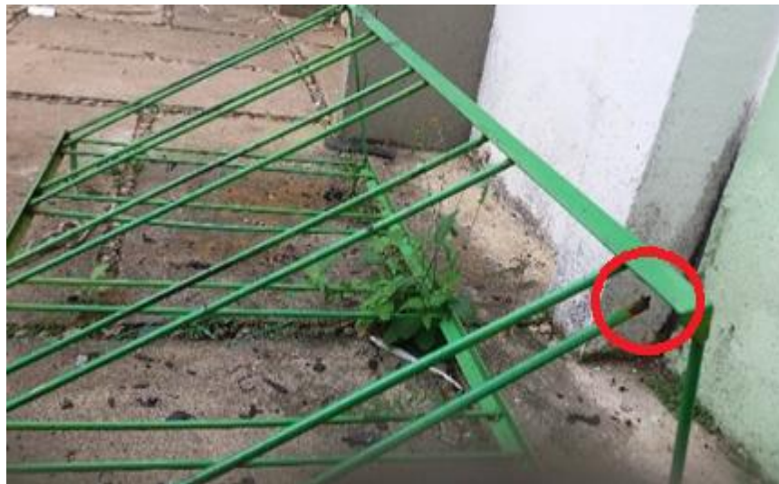
Figura 4. Bastidor mal soldado.
