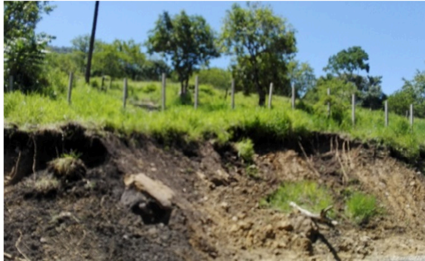
Imagen41. Colapso de cercas.
