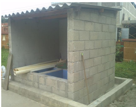
Foto 6. Cuarto de almacenamiento temporal de residuos líquidos peligrosos
