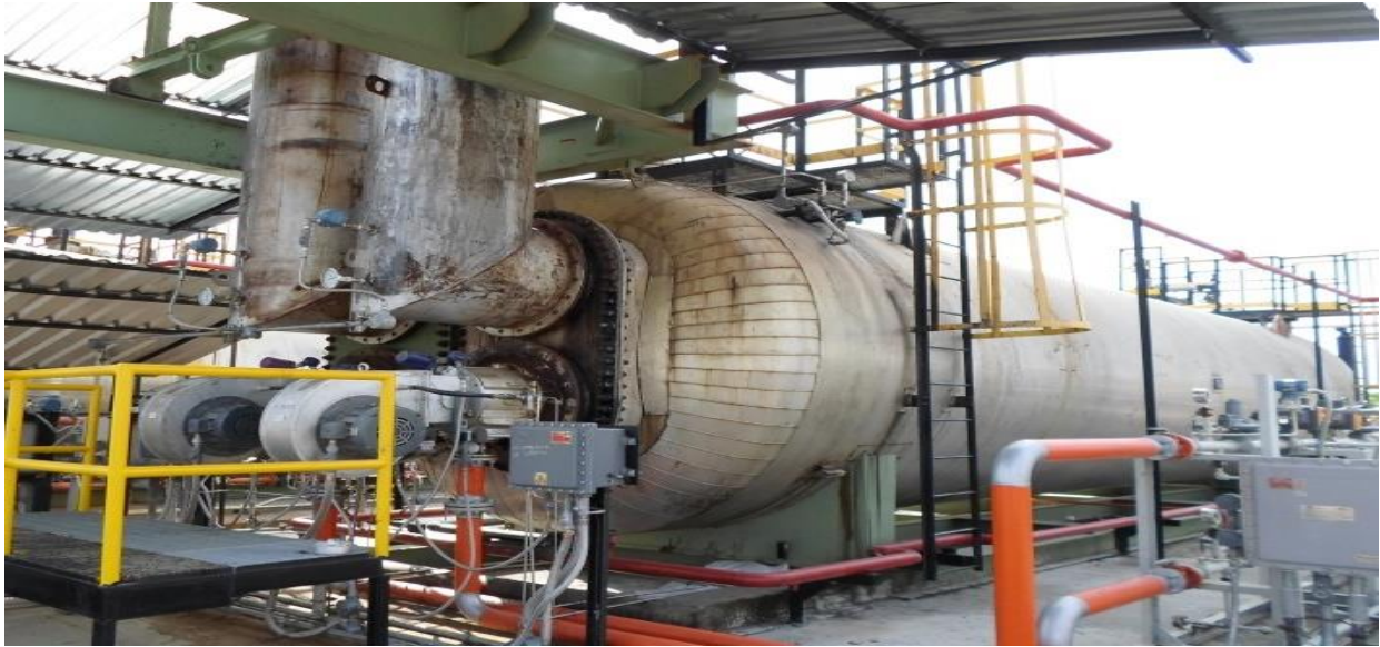
Fotografía 2. Sistema de combustión y chimeneas.
