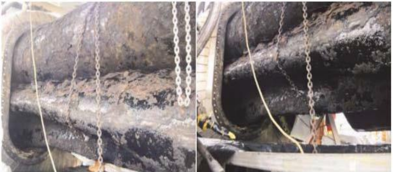
Fotografía 4. Deformación de tubos de fuego en calentadores
