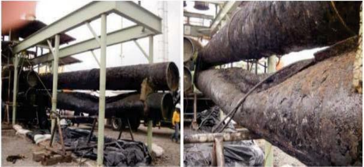
Fotografía 3. Deformación de tubos de fuego en los calentadores
