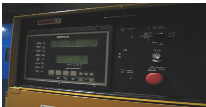
Figura 3.4. Panel de control.
