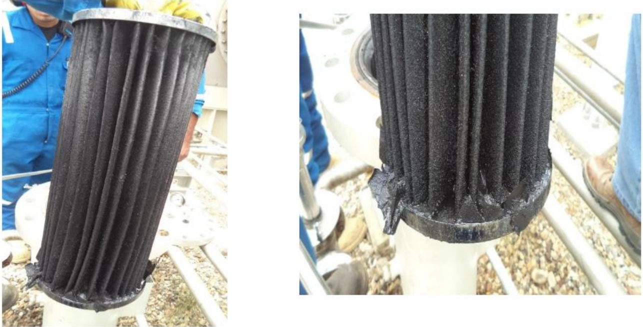
Ilustración 31. Contaminación de Glicol y carbón en elementos filtrantes de fuel gas de máquina.
