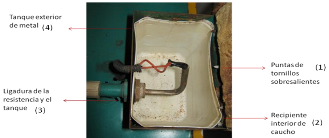
Figura 24: Tanque de Agua
