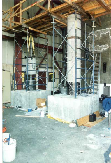
Figura 18. Chaqueta de acero en la zona de formación de rótula plástica.
