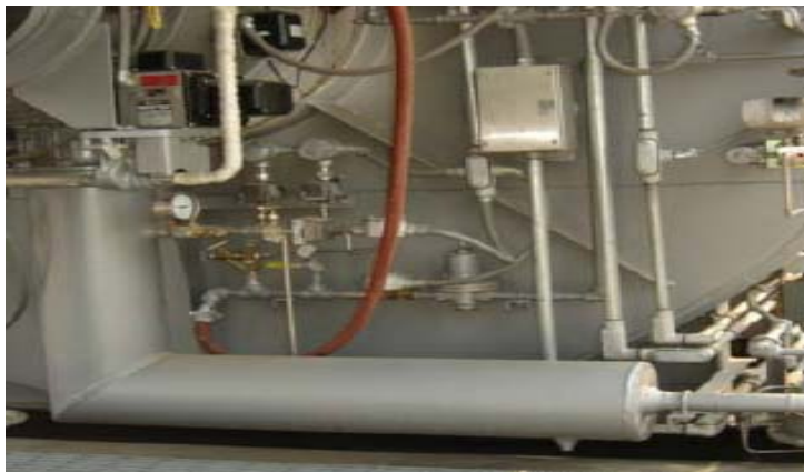
Figura 44. Sistema de combustible.
