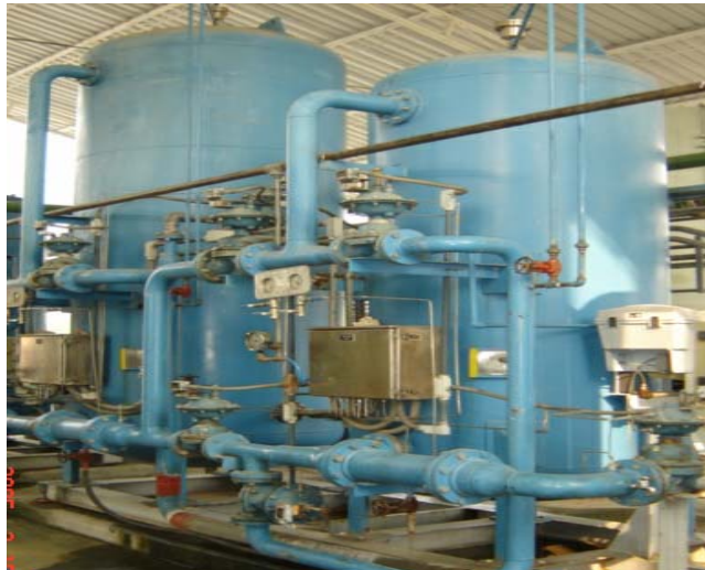
Figura 33. Tanques de Ablandamiento del agua.
