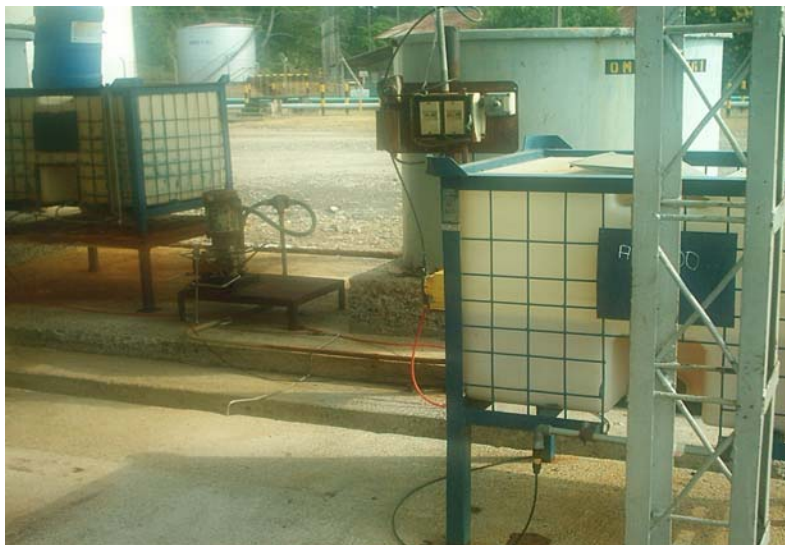
Figura 34. Tanques de inyección de químicos.
