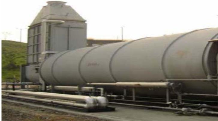
Figura 39. Precalentador de agua.
