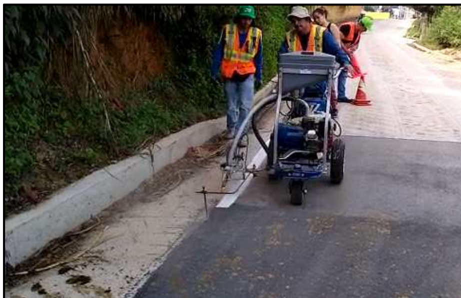
Figura 20. Demarcación de la vía
