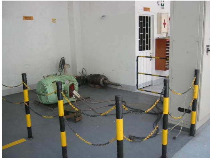
Figura 4. Zona de pruebas para verificación del estado del motor.
