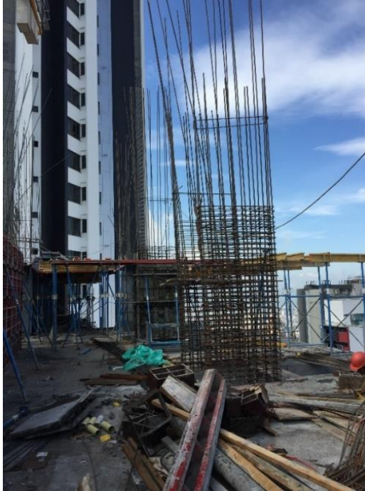
Figura 12. Condiciones iniciales orden y limpieza placa 20
