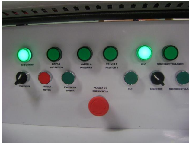
Figura 109. Tablero de mando.
