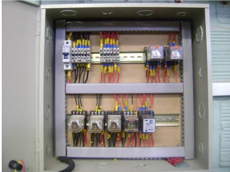
Figura 102. Tablero de potencia.
