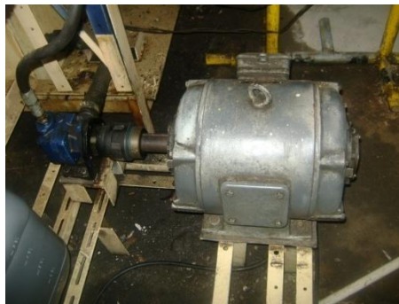
Figura 71. Motor eléctrico y bomba hidráulica.
