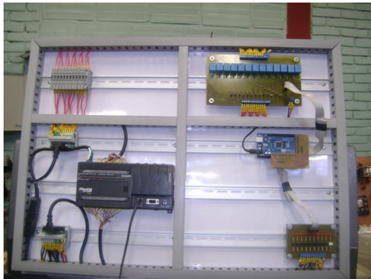
Figura 105. Panel con los componentes instalados.
