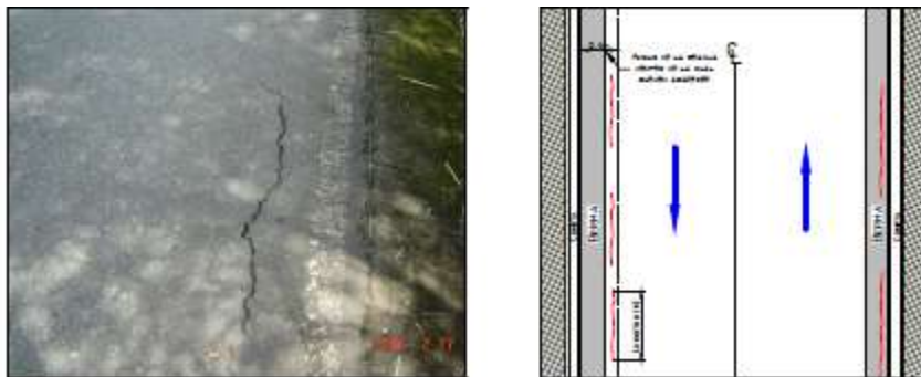
Figura 5. Fisuras de borde (FBD).
