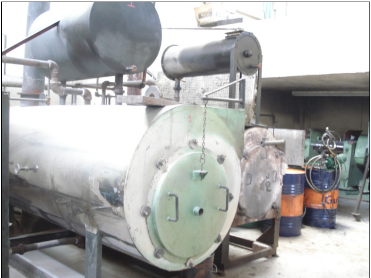
Figura 4. Caldera de Aceite Térmico
