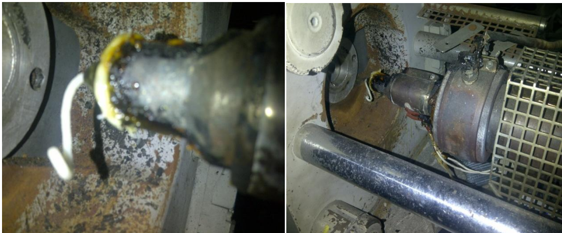
Figura 15. Obstrucción de boquillas.
