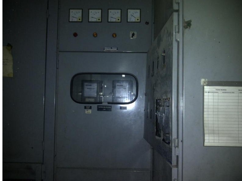
Figura 22. Central de potencia (eléctrico)
