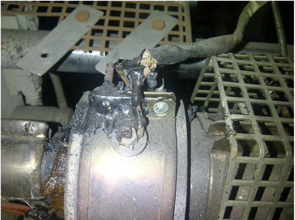
Figura 16. Derretimiento de cables de las resistencias eléctricas.
