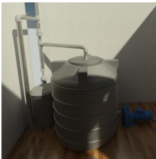
Figura 6. Tratamiento, almacenamiento y bombeo
