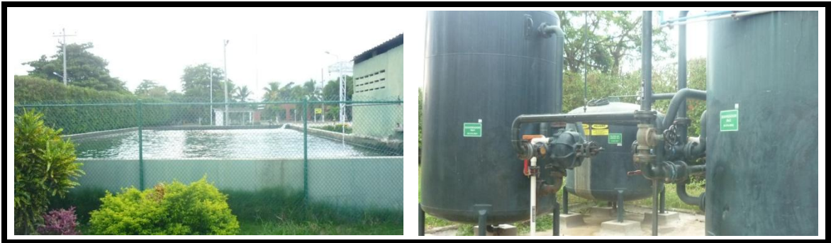
Figura 19. Área almacenamiento y tratamiento del agua. 23
