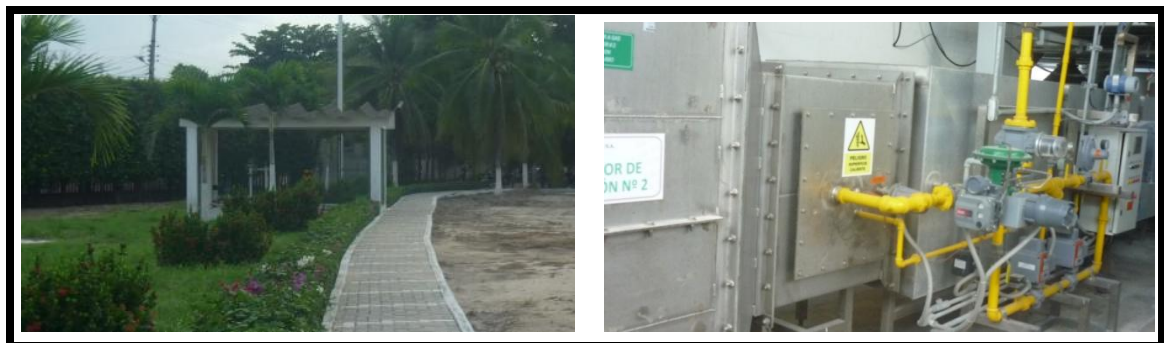
Figura 22. Estación de gas y quemador gas almidón. 27
