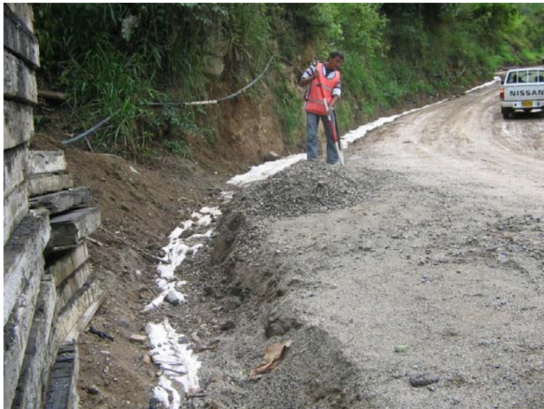
Figura No. 18 Filtros Terminados
