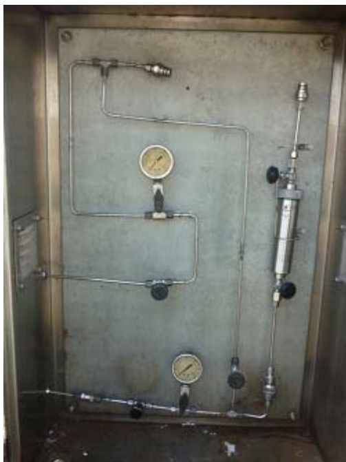
Figura 7. Estado Actual de los Tomamuestras ubicados en la NEGLP
