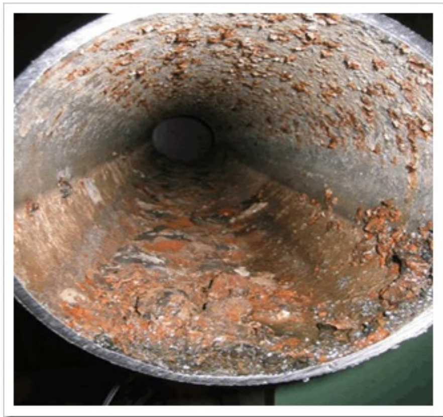
Figura 2. Corrosión en una tubería.
