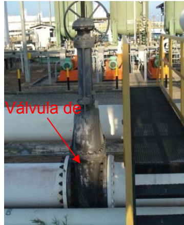
Figura 18: Válvula de compuerta en línea de flujo PF2
