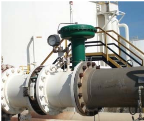
Figura 23: Válvula de control en línea de flujo PF2
