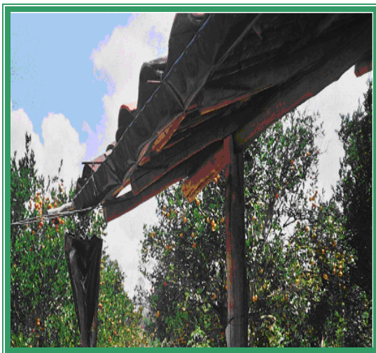
Canal extendido a lo largo del techo de la casa
