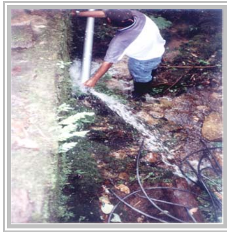
Conexión del desarenador a la tubería de conducción
