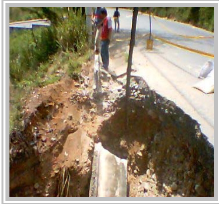
Sitio donde se realiza el cruce de la vía con el canal
