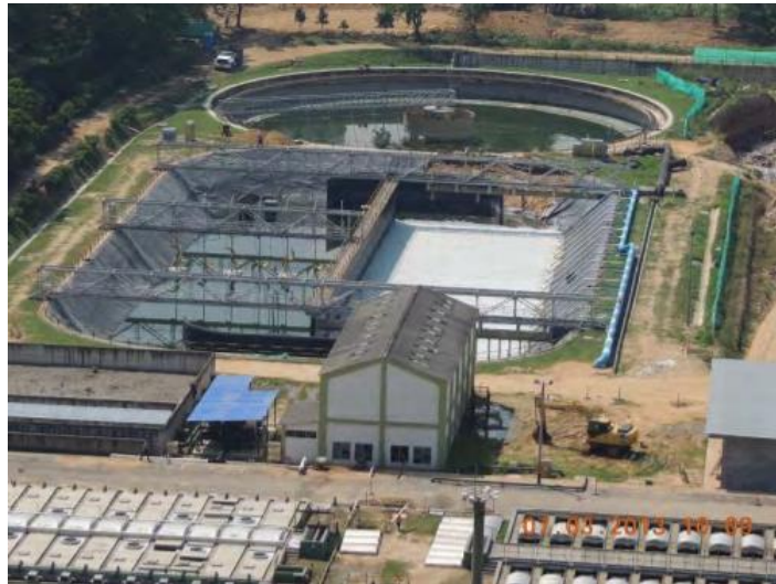
Figura 26. Tanque de aireación
