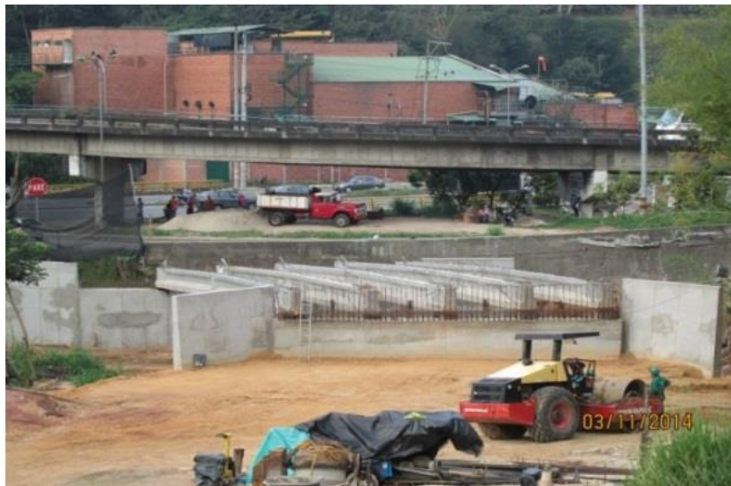
Figura 33. Estado actual del puente de acceso abadías.
