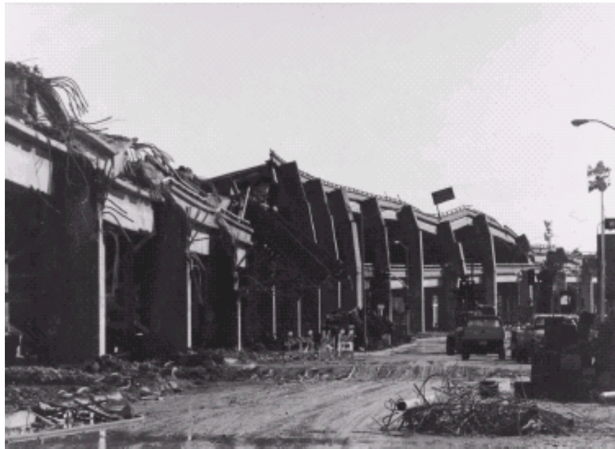
Figura 2.4 1 Colapso del viaducto Cypresen California en el sismo de Loma Prieta en 1989.
