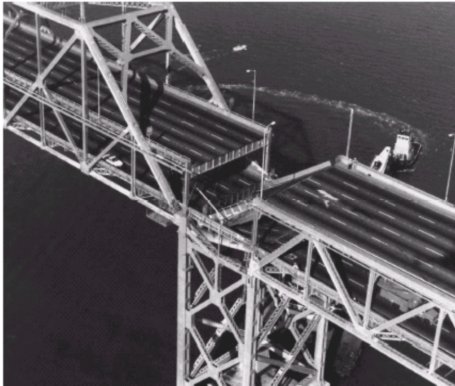
Figura 2.1 1 Colapso de la porción este del puente de san francisco en la bahia Oakland en el sismo de Loma Prieta en 1989.
