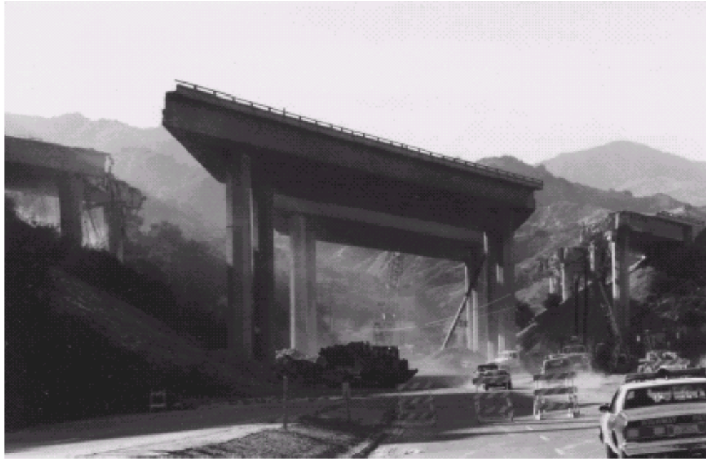
Figura 2.2 1 Colapso del cruce del cañon Gavin en California en el sismo de northridge en 1994.
