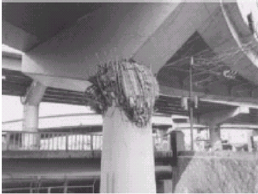
Figura 3.3 1 Detalle de columna con rotulación plástica en el intercambiador de Minatogawa, durante la sismo de Kobe.
