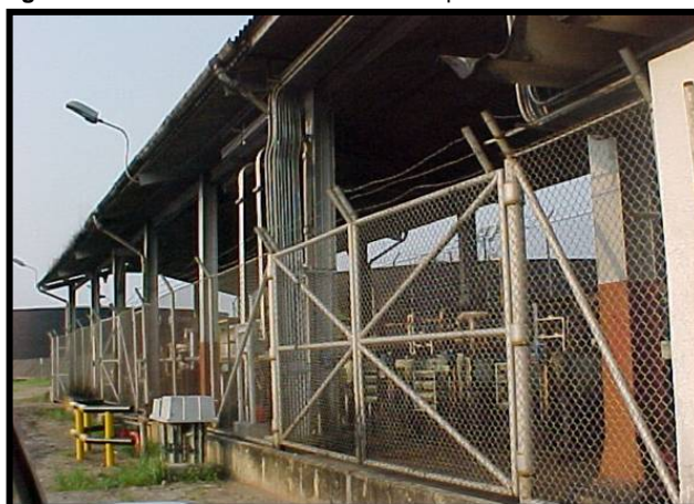
Figura 7. Vista del Llenadero de Carrotanques.
