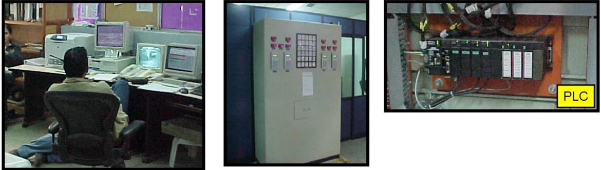
Figura 14. Cuarto de control CB8, Gabinete de los computadores de flujo OMNI, PLC de la central.
