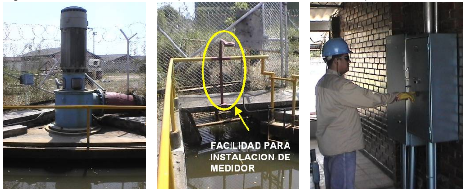
Figura 1. Bomba Goulds®; Facilidad para instalación del medidor; Modo de operación actual.
