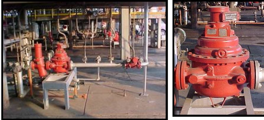
Figura 3. Líneas de despacho de producto refinado, Medidor de desplazamiento positivo del llenadero.
