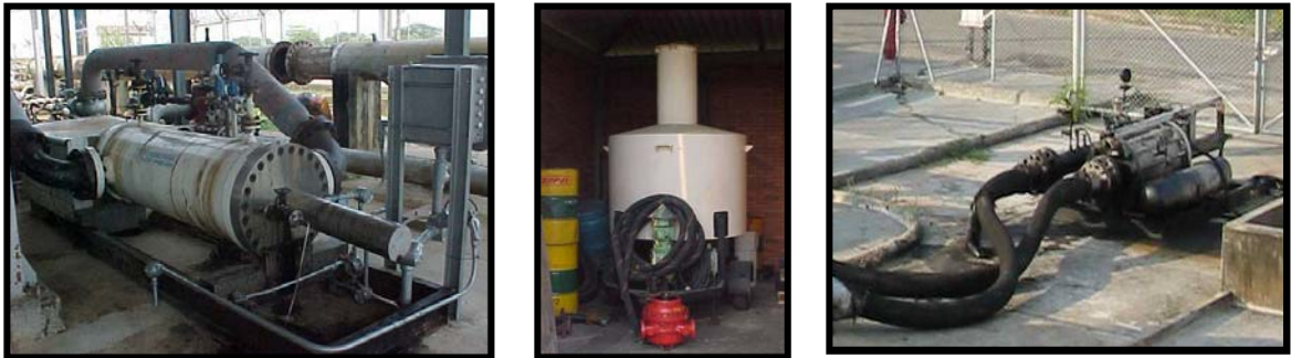
Figura 39. Probador Compacto de la CB8, Probador Tipo Tanque del llenadero de Carrotanques, Probador bidireccional Cb7.
