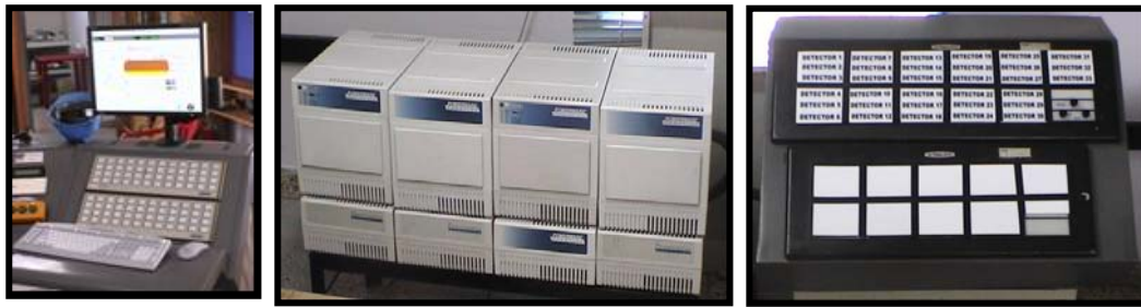
Figura 16. Computadores de monitoreo del proceso, UPS's, Control de alarmas de la planta.
