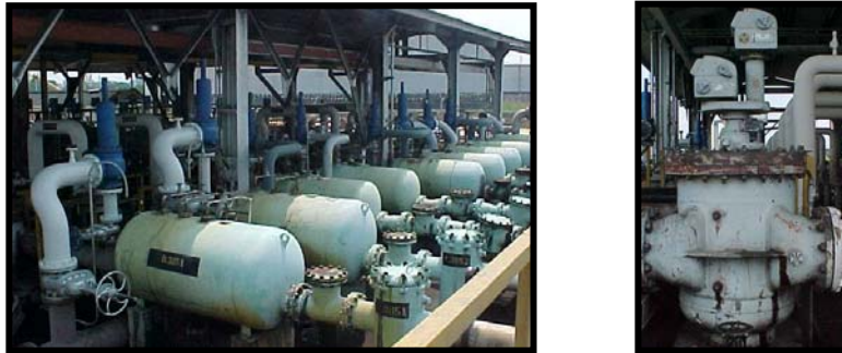
Figura 13. Líneas de recibo de crudo y medidor de desplazamiento positivo.
