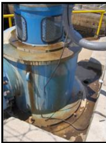
Figura 41. Falla de la Bomba.
