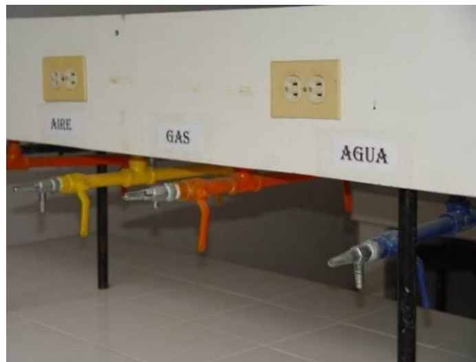
Figura 24. Tuberías debidamente marcadas
