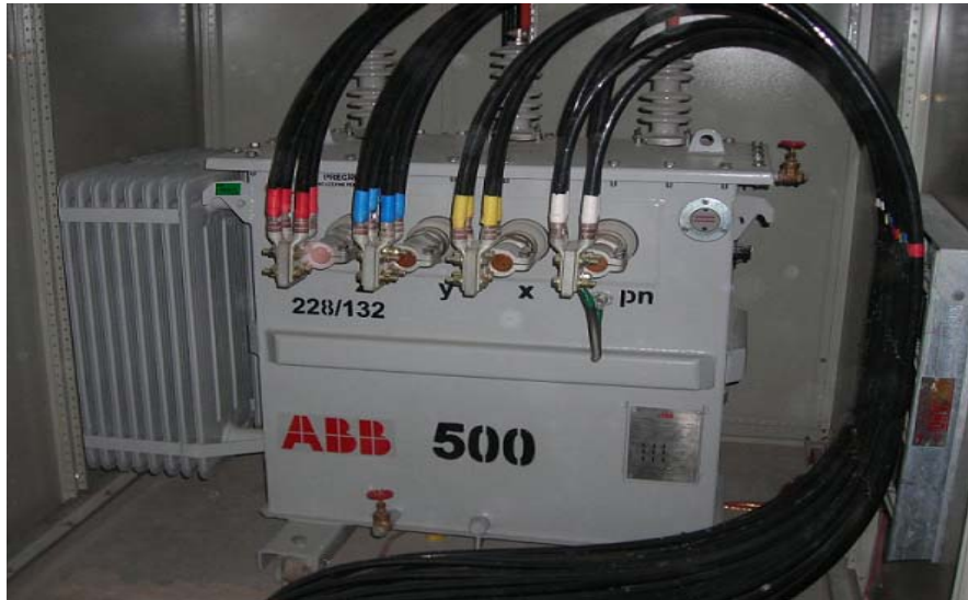
Figura 3. Transformador (A) del edificio CENTIC (fuente autor)
