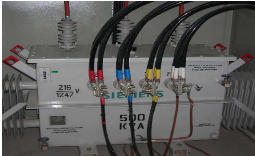
Figura 9. Transformador B del edificio CENTIC (fuente autor)
